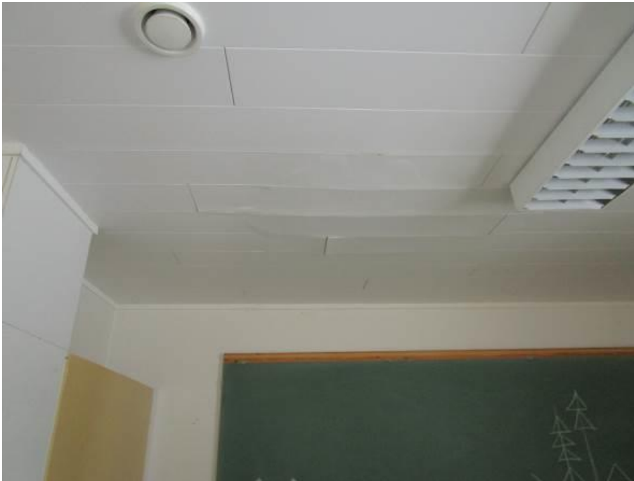
Kuva 95. Keittiö ja katossa oleva kosteusvaurio
