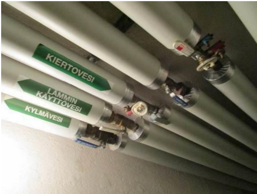
Kuva 146. Käyttövesiputkistoja kellarin käytävällä
