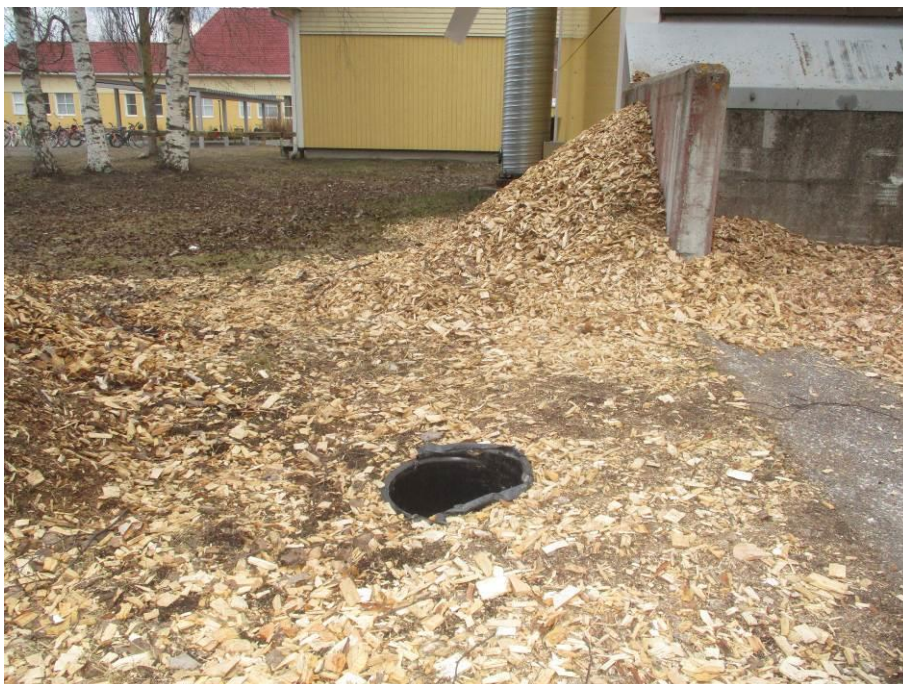
Kuva 10. Salaojan tarkistuskaivojen kannet rikki.
