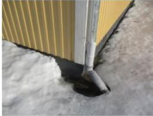
Kuva 8. Lyijyä sisältävä sokkelimaali.
