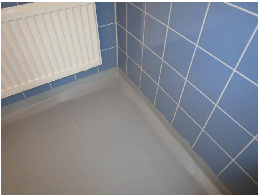
Kuva 19. Painuman myötä muovimaton ylösnostot ovat irronneet.
