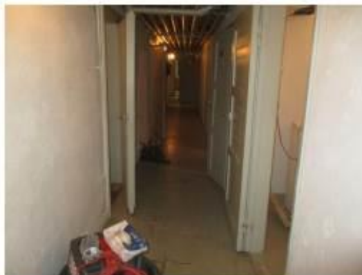
Kuva 6. Raskasmetalleja sisältävä lattiamaali.
