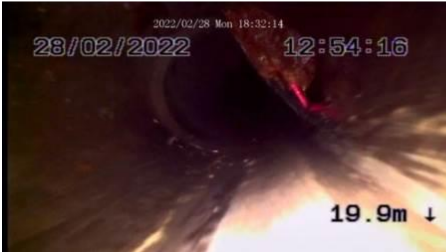
Kuva 157. Kuvaus 5 (viemäritutkimusraportissa kuvaus 4): Irtonainen tiiviste
