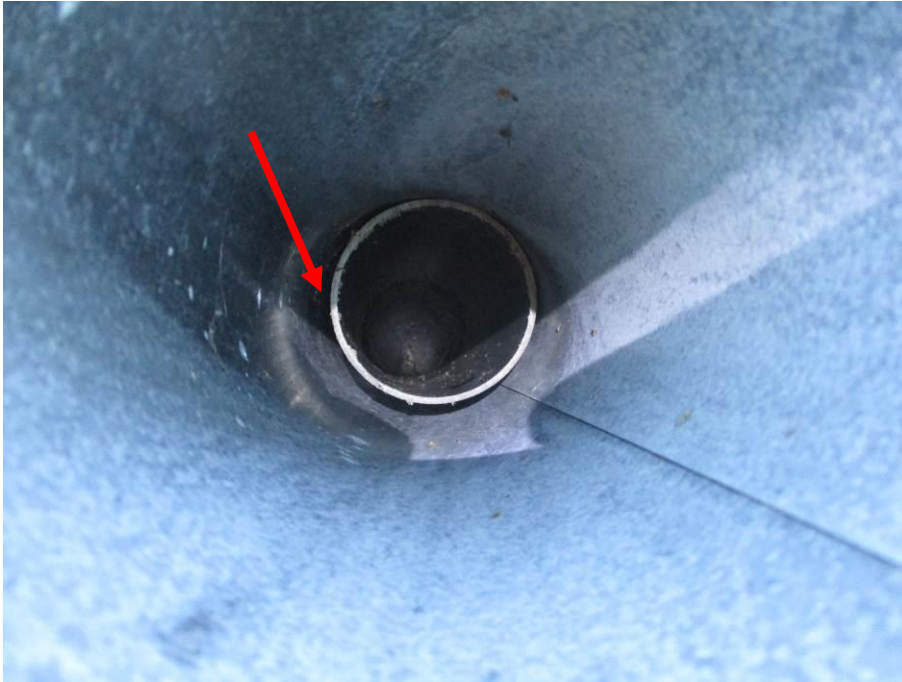
Kuva 72. Viemärin jatkeena on käytetty vesikaton osalla ilmanvaihtoputkea.
