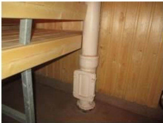
Kuva 9. Lyijyä sisältävät viemäriputkitiivisteet.
