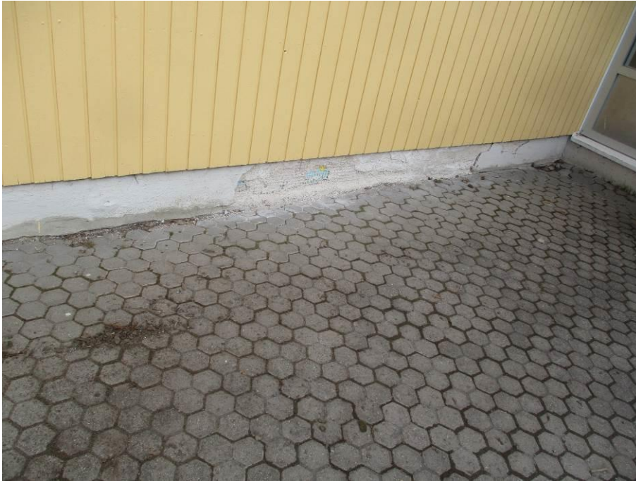
Kuva 16. Päärakennuksen sokkelin pinta heikossa kunnossa.
