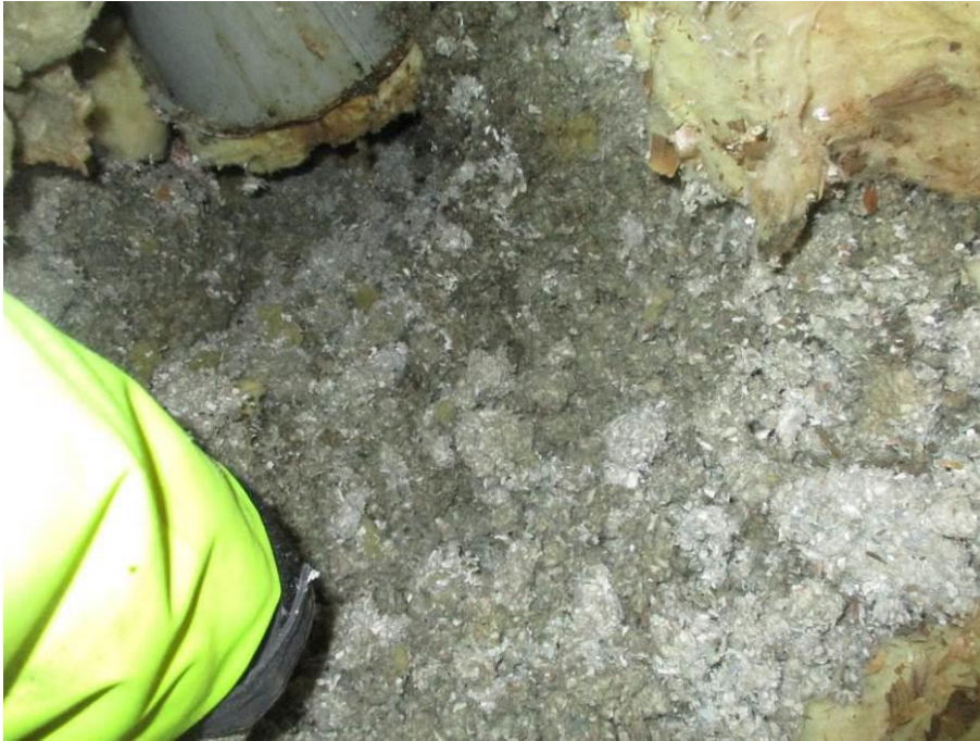
Kuva 81. Yläpohjan villat ovat laajalta alalta märät tuuletusputken alta.
