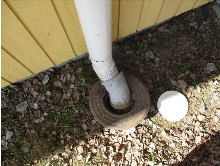
Kuva 13. Sadevedet johdettu suoraan sadevesiviemäriin.
