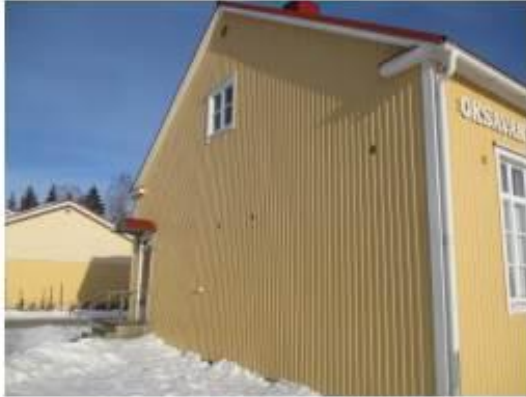
Kuva 7. Lyijyä sisältävä ulkoseinämaali.
