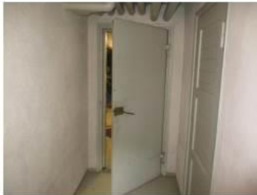
Kuva 4. Asbestia sisältävät palo-ovet.
