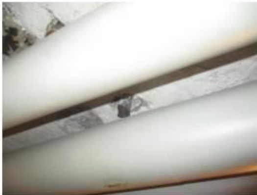
Kuva 3. Asbestipitoisia putkieristeitä läpiviennissä.
