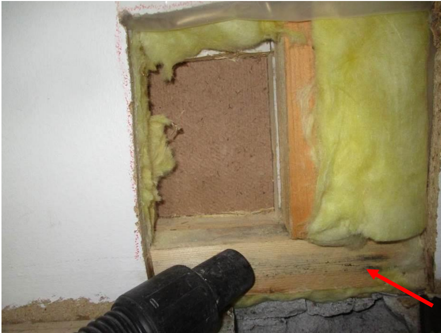
Kuva 50. Sisäpuolisessa koolauksessa on värimuutoksia.
