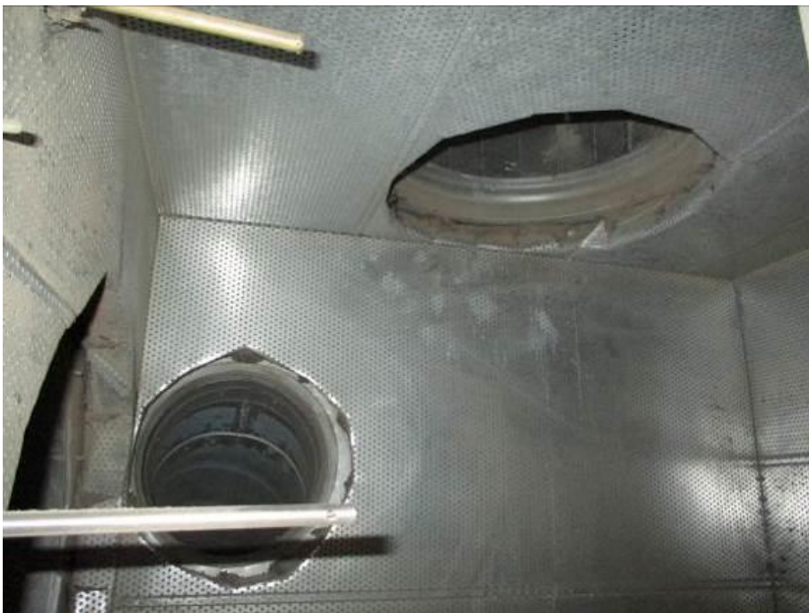
Kuva 166. Tuloilmakammiossa mineraalivillaeristys reikäpellillä Keittiön poistopuhaltimessa PF-2 ei havaittu huomautettavaa.
