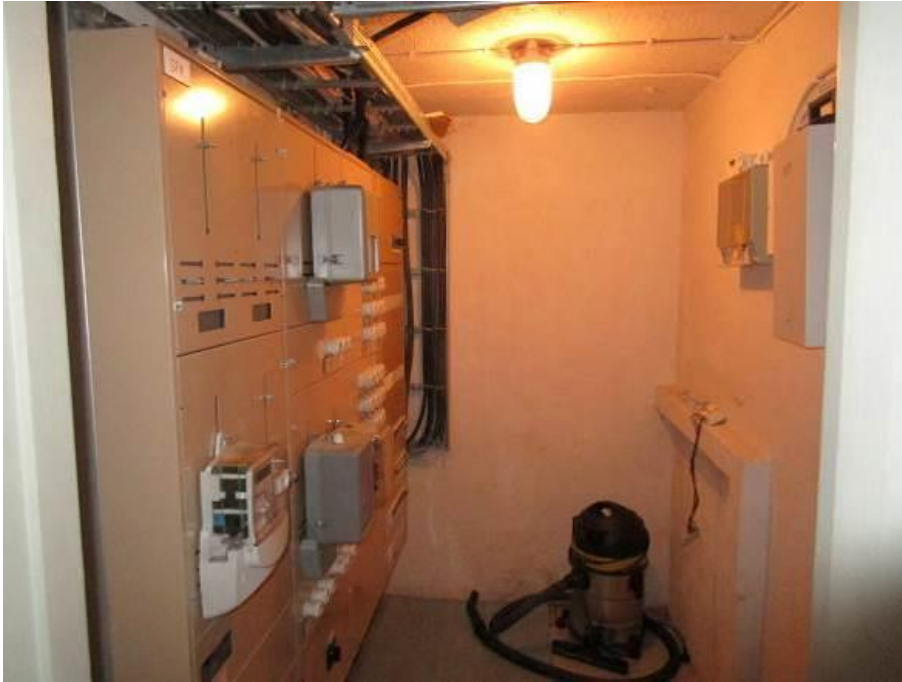
Kuva 179. Sähköpääkeskus ja mittarikeskus.
