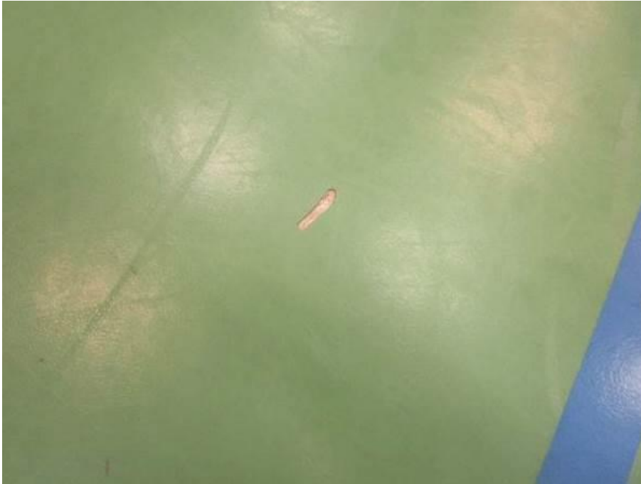
Kuva 112. Liikuntasalin lattiassa reikä
