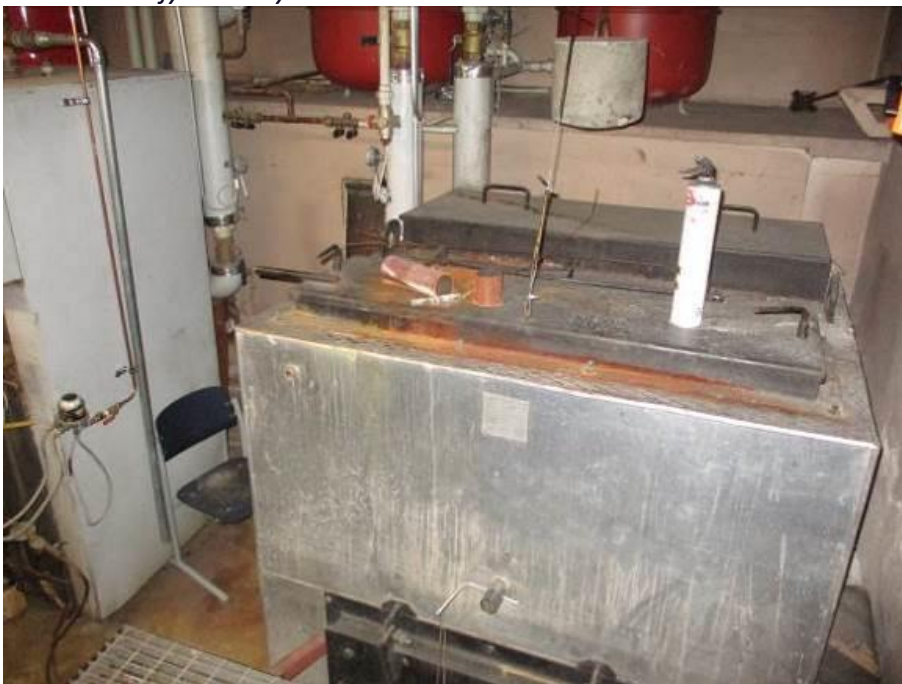
Kuva 140. käytöstä poistettu kattila
