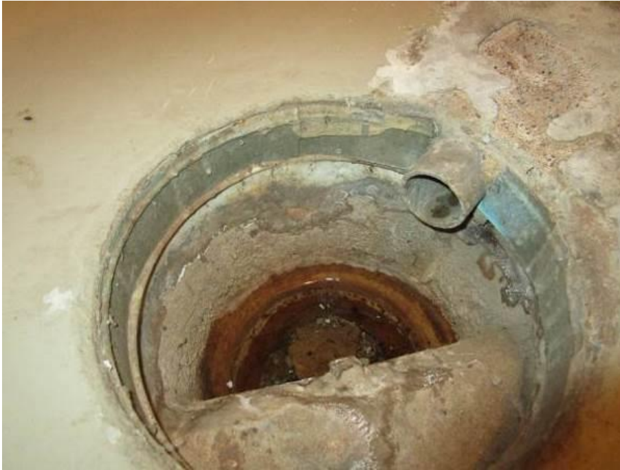
Kuva 89. Pyykkituvan valurautainen lattiakaivo
