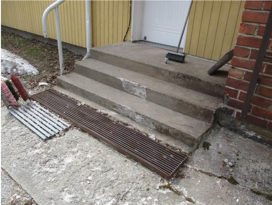
Kuva 8. Betoniportaat ovat sammaloituneet.
