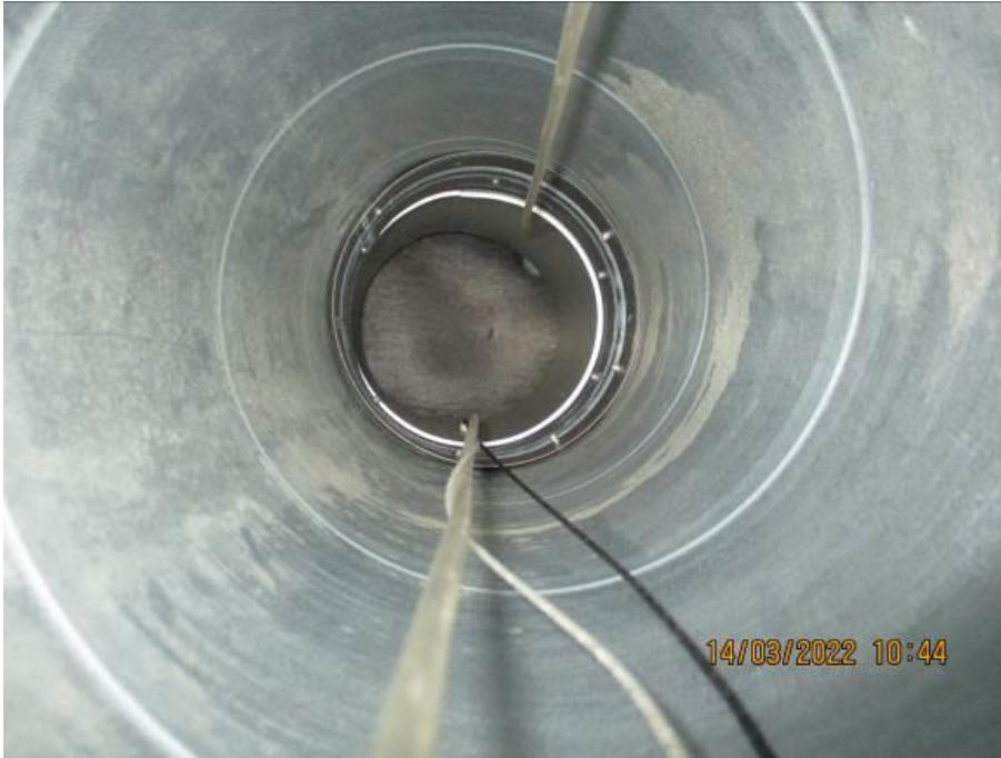
Kuva 178. Yläpohjassa olevissa paineenalennuslaitteissa mineraalivillaeriste
