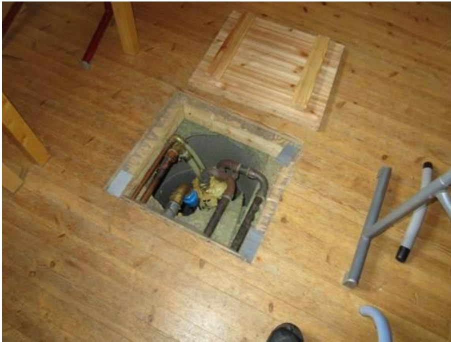
Kuva 144. Kanaalista tulevat putket vanhassa koulurakennuksessa
