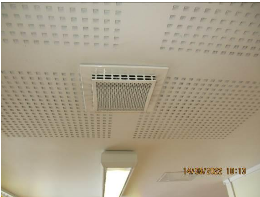
Kuva 175. THA-mallin katossa oleva tuloilmapäätelaitte ja
