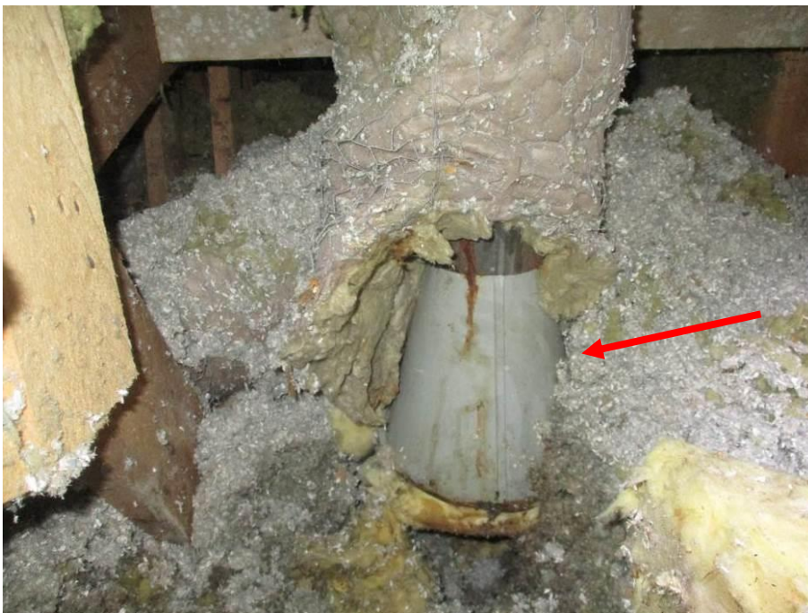
Kuva 82. Viemärin tuuletusputken vanha läpivientikartio.
