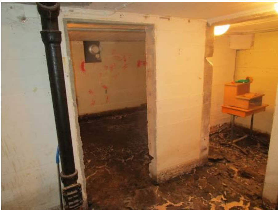
Kuva 150. Esikoulun kellarissa olevia pystyviemäreitä
