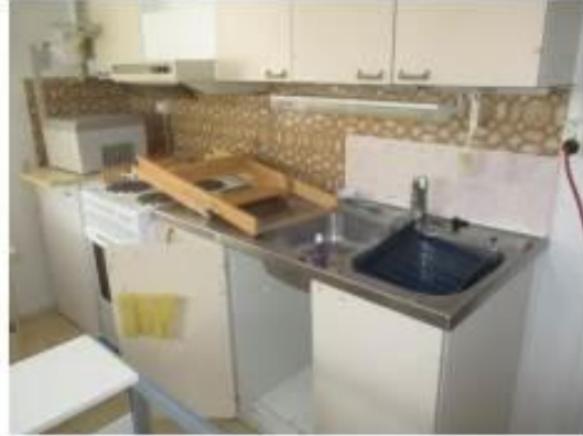
Kuva 2. Asbestia sisältävä välitilan seinämatto.
