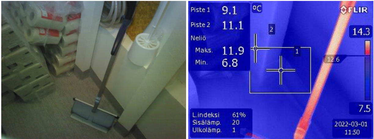
Kuva 35. Siivousskomerossa vuotoilmaa alapohjasta.
