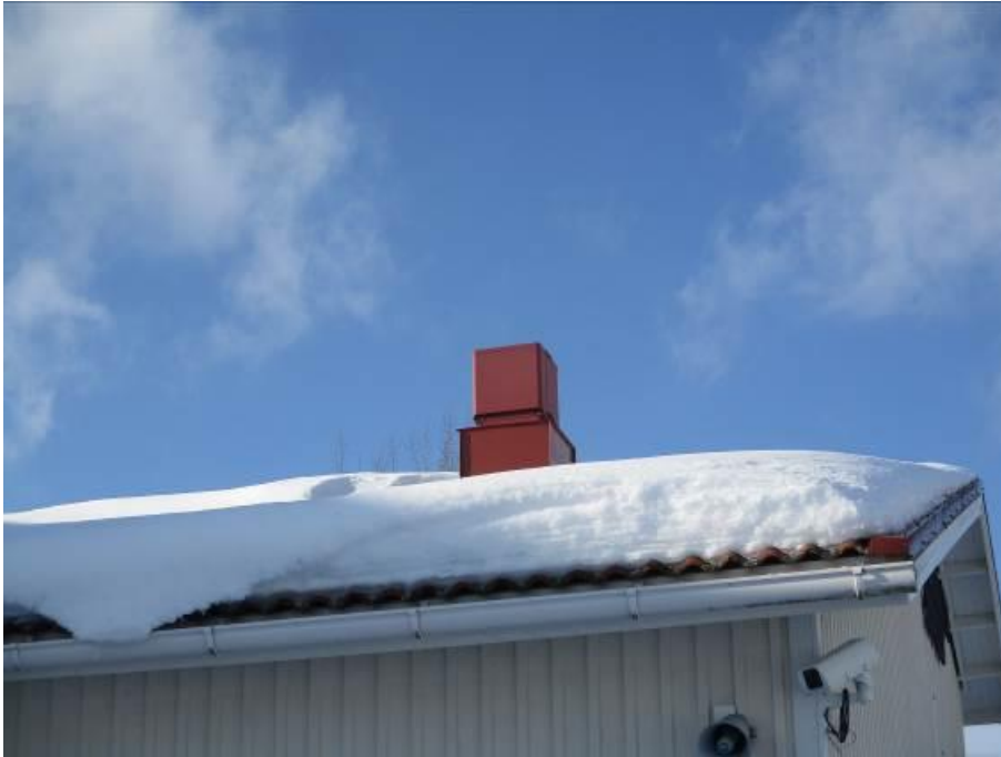
Kuva 189. TK04/PK02 poistopuhallin katolla
