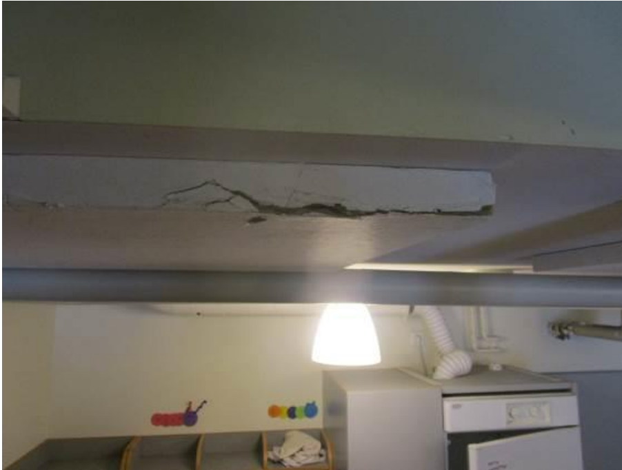
Kuva 127. Akustolevyjen reunoja rikki
