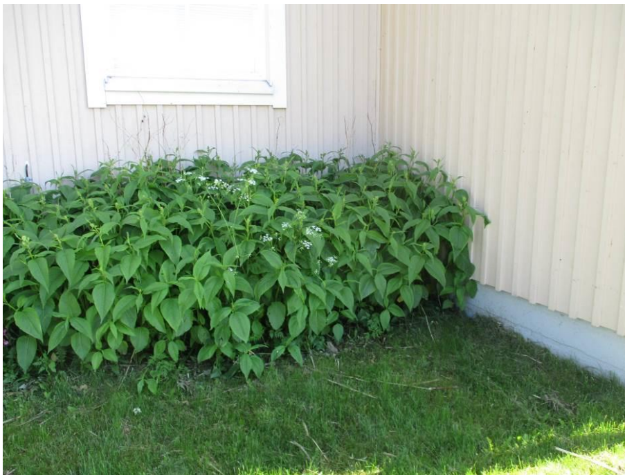
Kuva 3. Takapihan puolella pensaikko kasvaa rakennuksessa kiinni.
