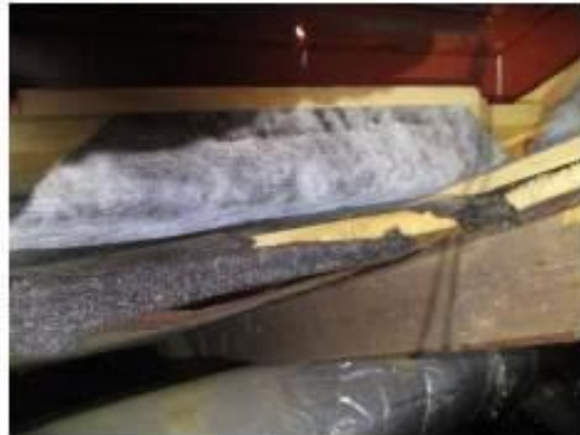
Kuva 4. Asbestia sisältävä vanha kattoluopa.
