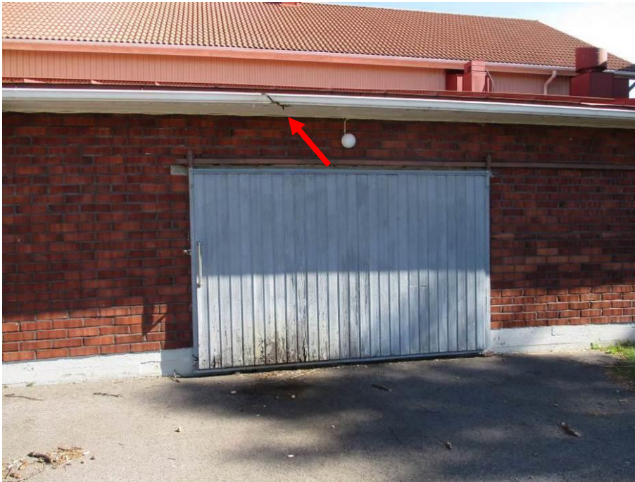
Kuva 12. Teknisen tilan osalla räystäskouru on puhki.
