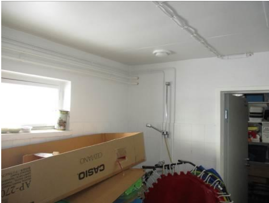
Kuva 157. Varastotilassa 122 olevissa vesikalusteissa paineet päällä
