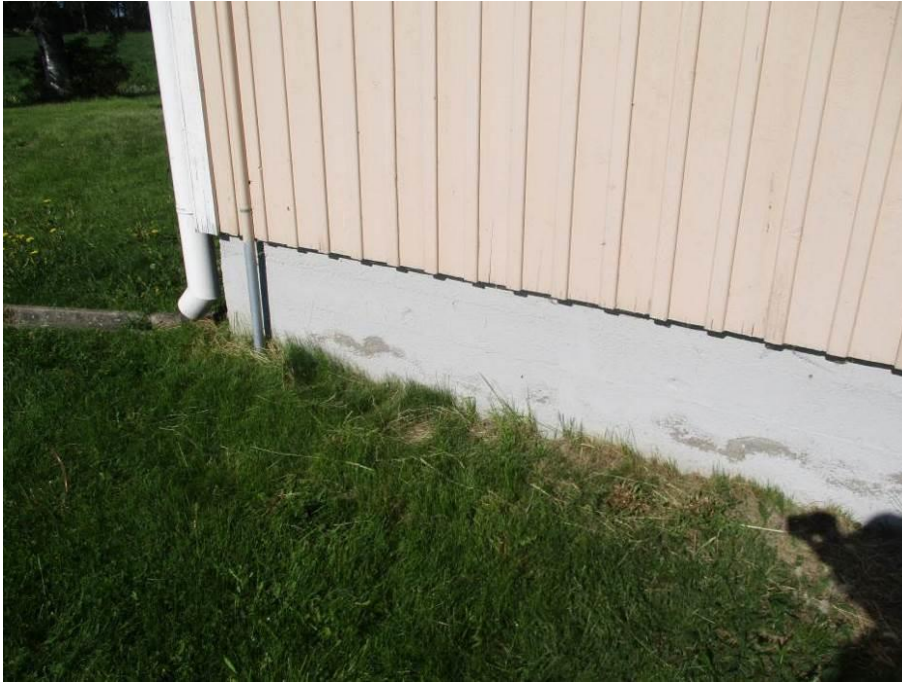
Kuva 19. Sokkelin maalipinta hilseilee.
