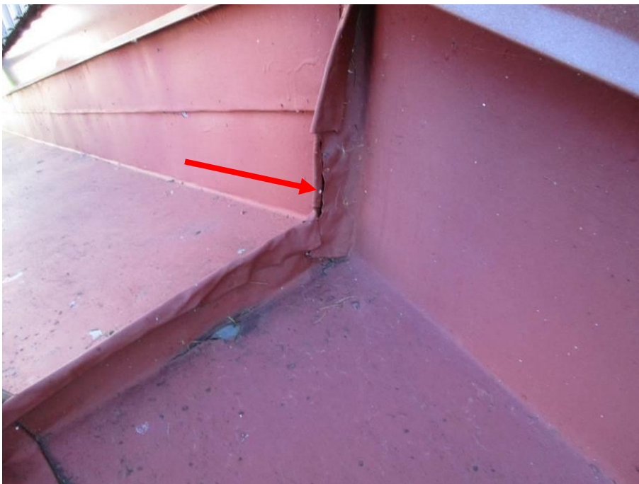
Kuva 79. Ylösnoston harjasauma epätiivis.
