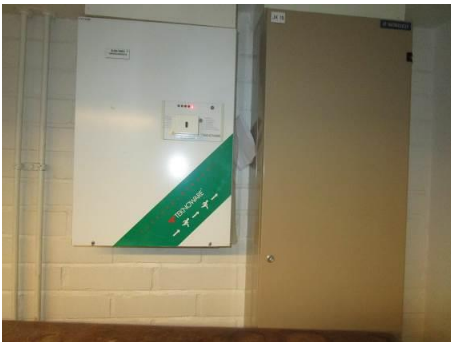
Kuva 214. Turvavalokeskus liikuntasalin käytävällä
