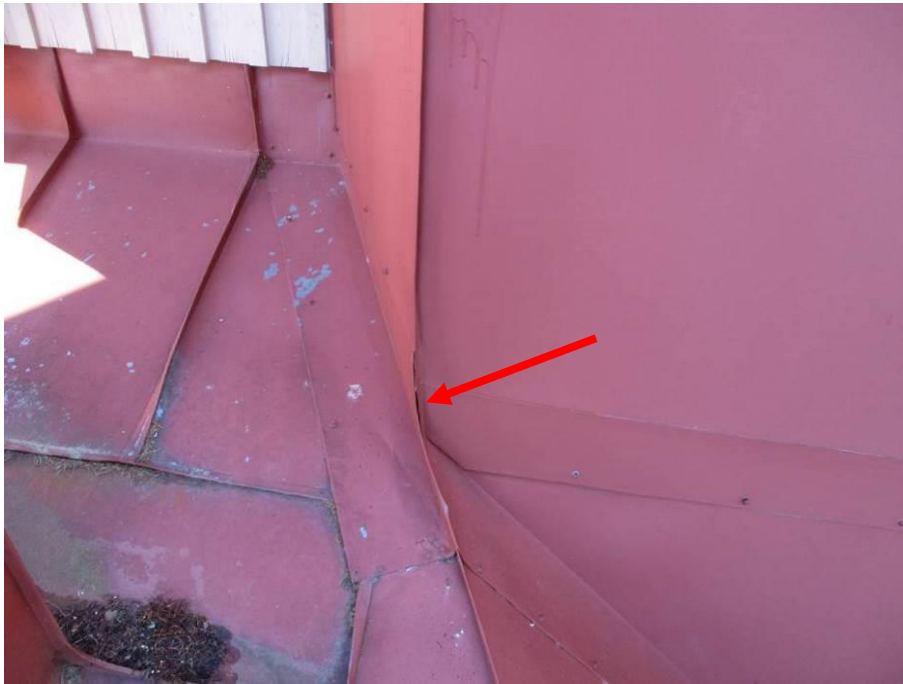
Kuva 80. Kotelon saumaus on epätiivis.
