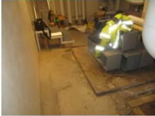
Kuva 1. LJH lattiamaaliin kontaminoitunut asbesti-kuituja.
