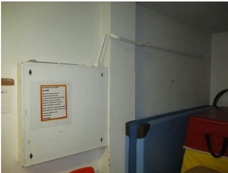
Kuva 144. Liikuntasalin pikapalopostin vesijohdon kannakointi puutteellinen
