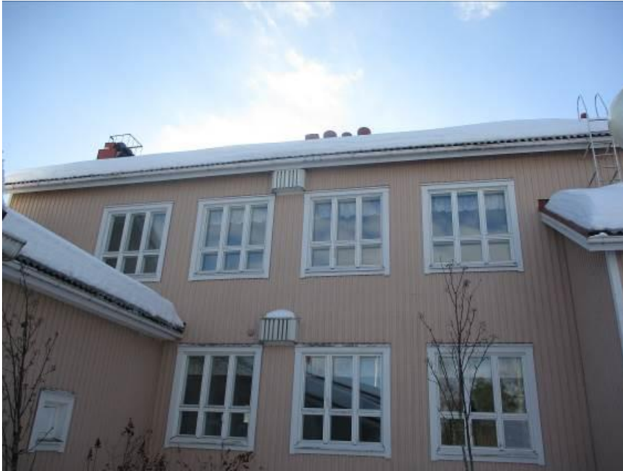
Kuva 178. TK02 ja TK03 raitisilmäsäleiköt seinällä
