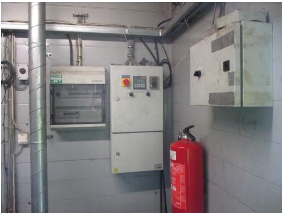
Kuva 211. Kattilakontissa olevia keskuksia.
