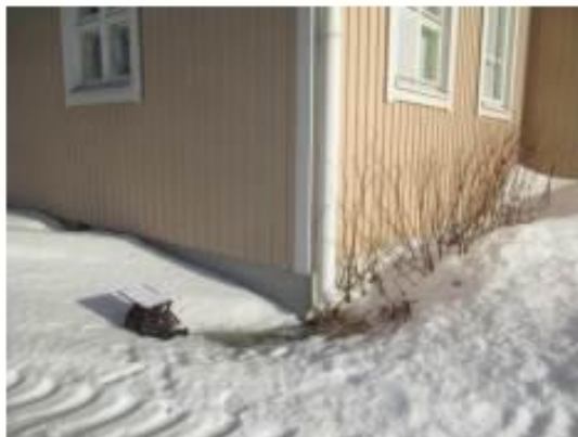
Kuva 9. Raskasmetalleja sisältävä sokkelimaali.
