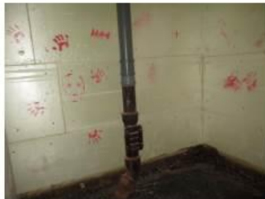
Kuva 10. Lyijyä sisältävät viemäriputkiyhteet.
