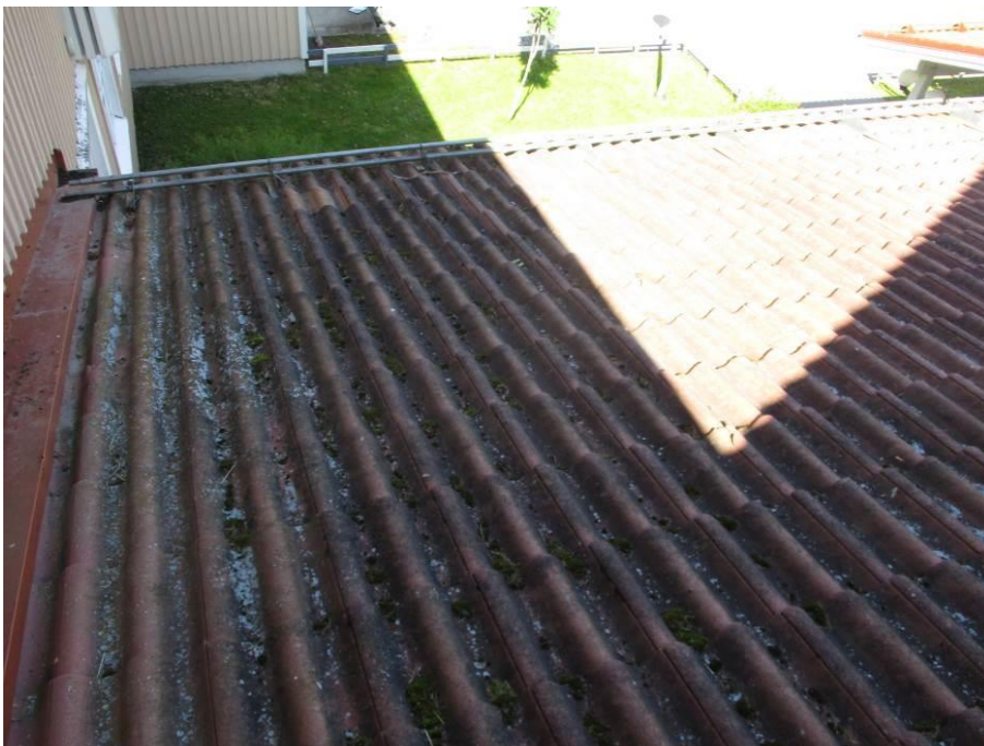
Kuva 82. Tiilen pinta on sammaloitunut.
