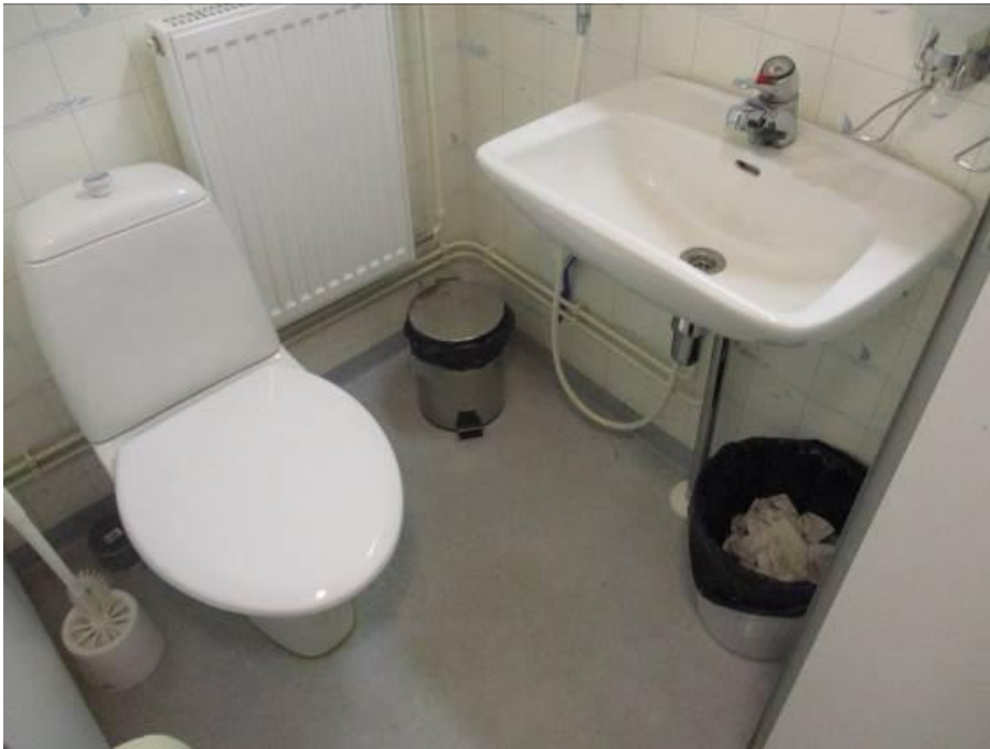
Kuva 156. Yläkerran tilassa 205 olevia vesikalusteita
