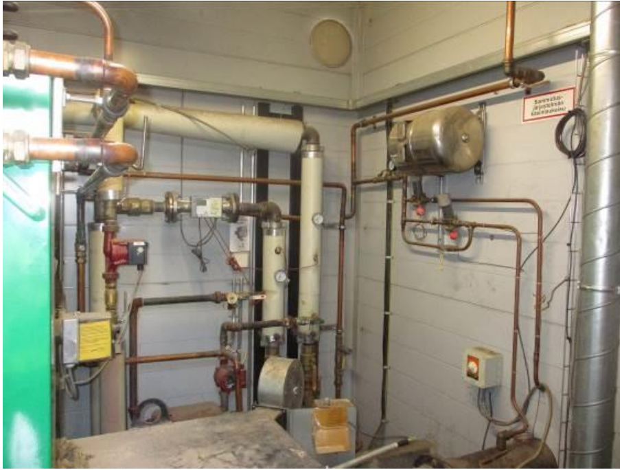
Kuva 134. Kontissa olevia putkia ja laitteistoja.
