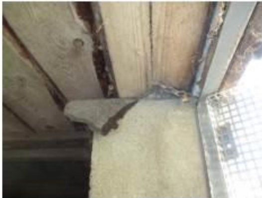
Kuva 3. Asbestia sisältävä huopakaista.
