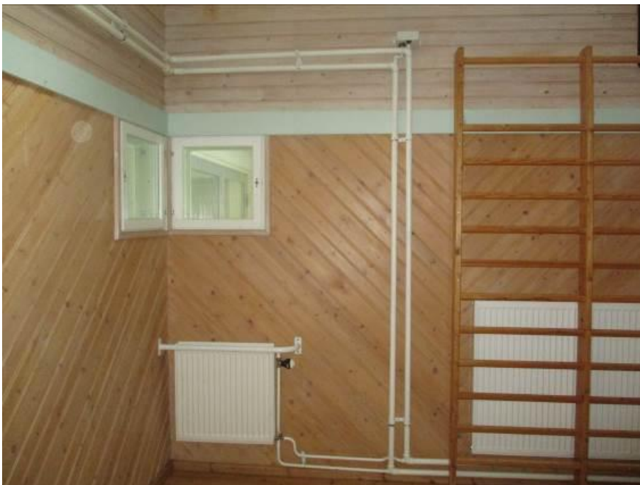
Kuva 140. Liikuntasalin seinällä olevia lämmitysputkistoja
