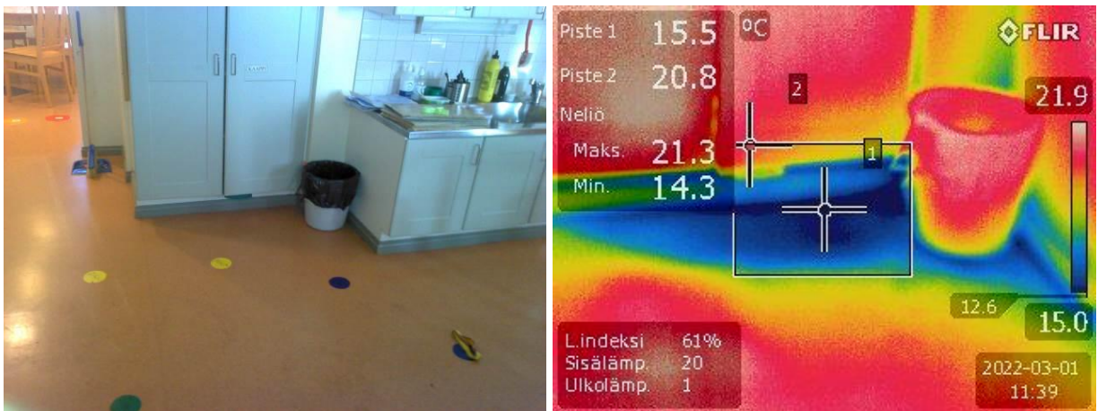
Kuva 36. Esikoulun keittiössä vuotoilmaa.
