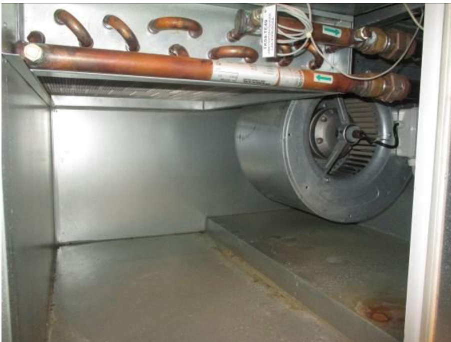
Kuva 186. Jälkilämmityspatteri ja puhallin
