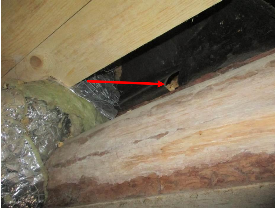
Kuva 29. Puutyöluokan kohdalla eristys on purua.
