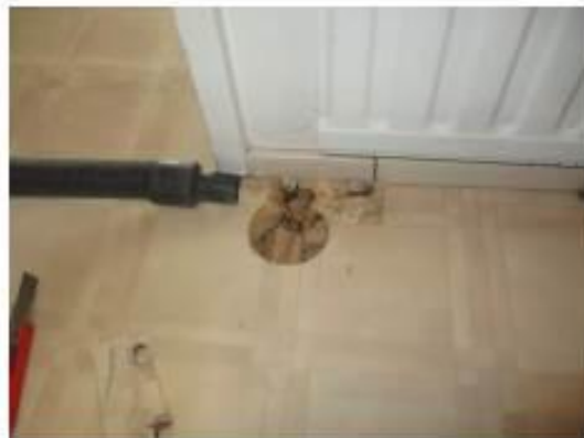
Kuva 6. Asbestia sisältäviä putkieristeitä rakenteissa.
