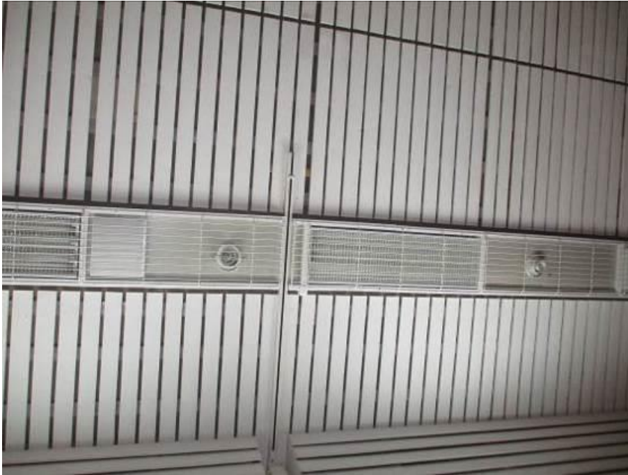
Kuva 166. Liikuntasalin katossa olevia tuloilmasuulakkeita
