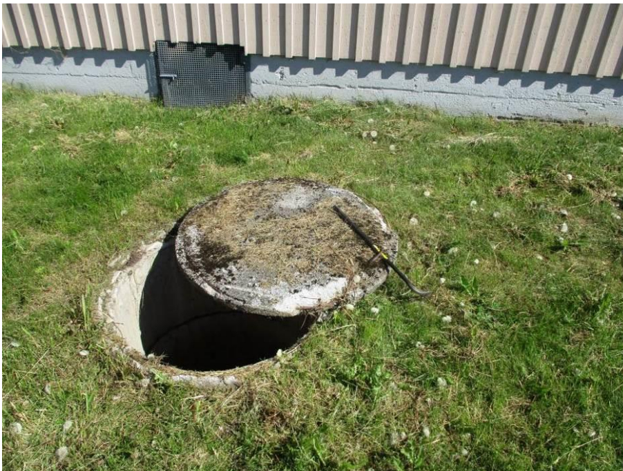
Kuva 15. Vesikaivo takapihan puolella.
