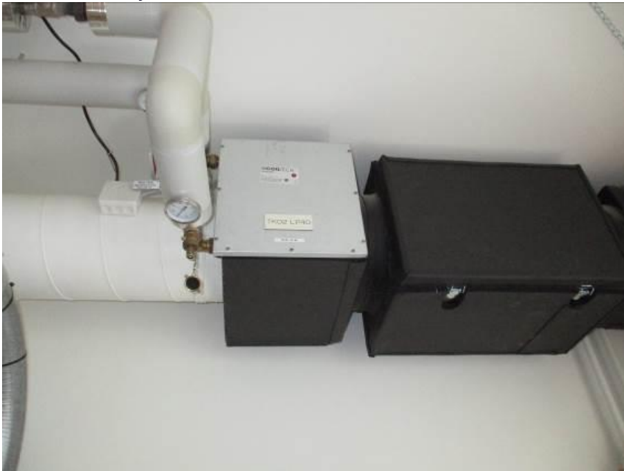
Kuva 179. korvausilmakanavassa oleva kanavalämmitin ja suodatinkotelo
