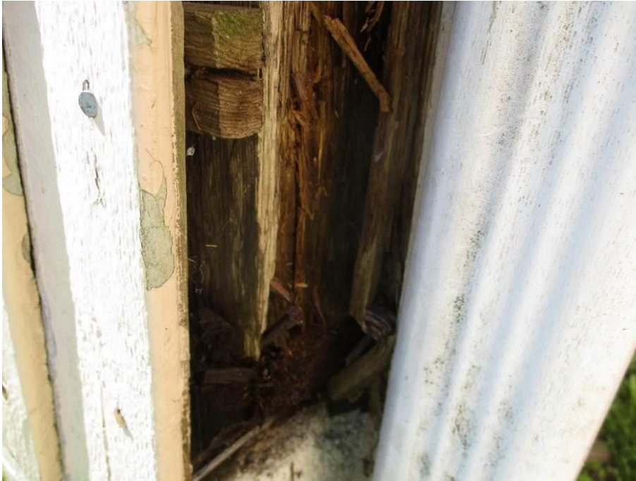
Kuva 8. Pilarin juuri on lahonnut.
