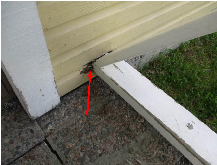
Kuva 13. Katoksen kaide on lahonnut.
