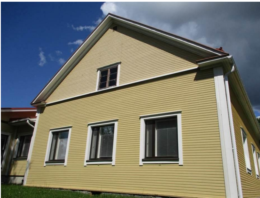
Kuva 62. Päätykolmion maalipinta on heikko.
