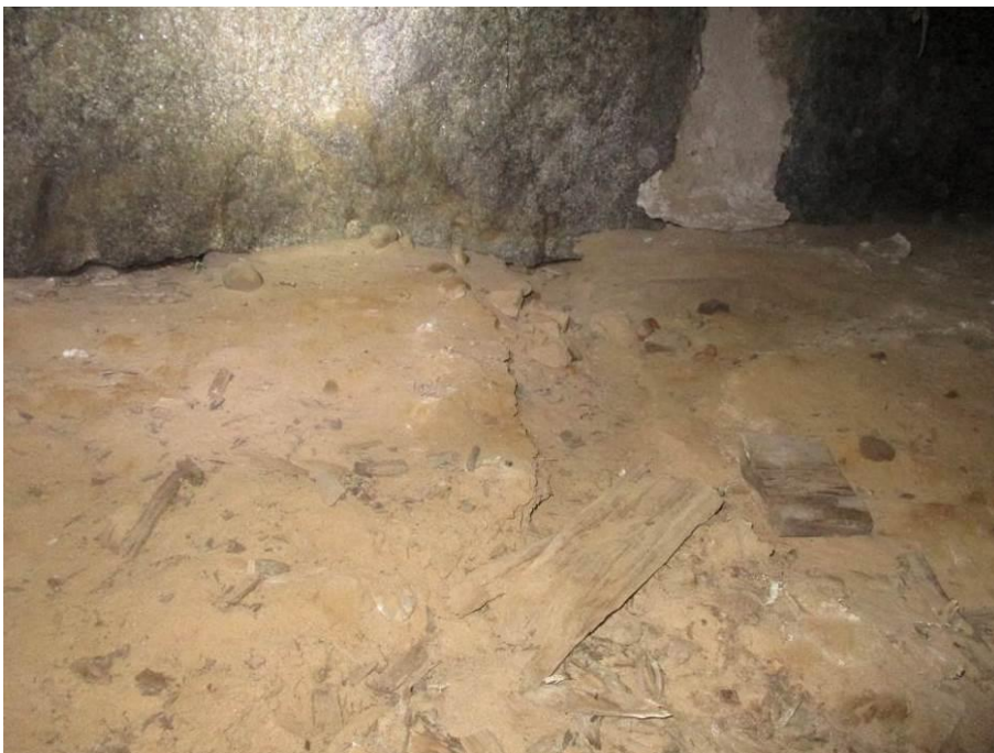
Kuva 29. Alapohjaan valuu pintavettä etupihan puolelta.
