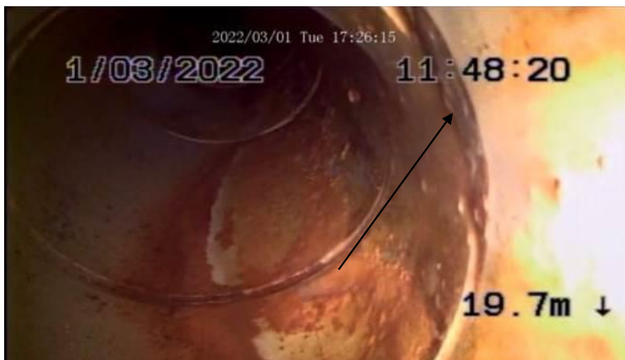
Kuva 166. Kuvaus 3. Huonosti paikallaan oleva tiiviste
