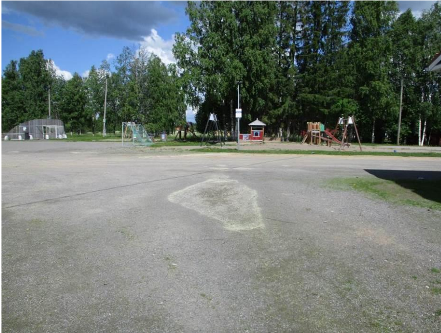
Kuva 6. Vesi lammikoituu pihalle.
