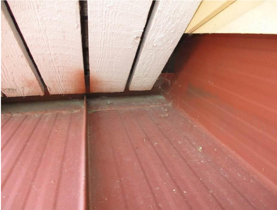
Kuva 74. Liikuntasalin räystäään alla vesikate on epätiivis.
