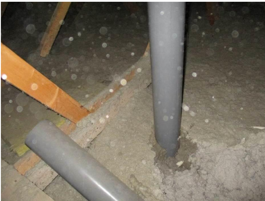
Kuva 90. Märkiä villoja yläpohjassa.
