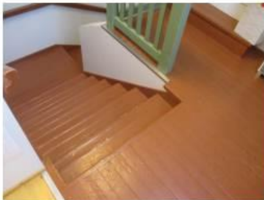
Kuva 3. Raskasmetalleja sisältävää lattiamaalia.
