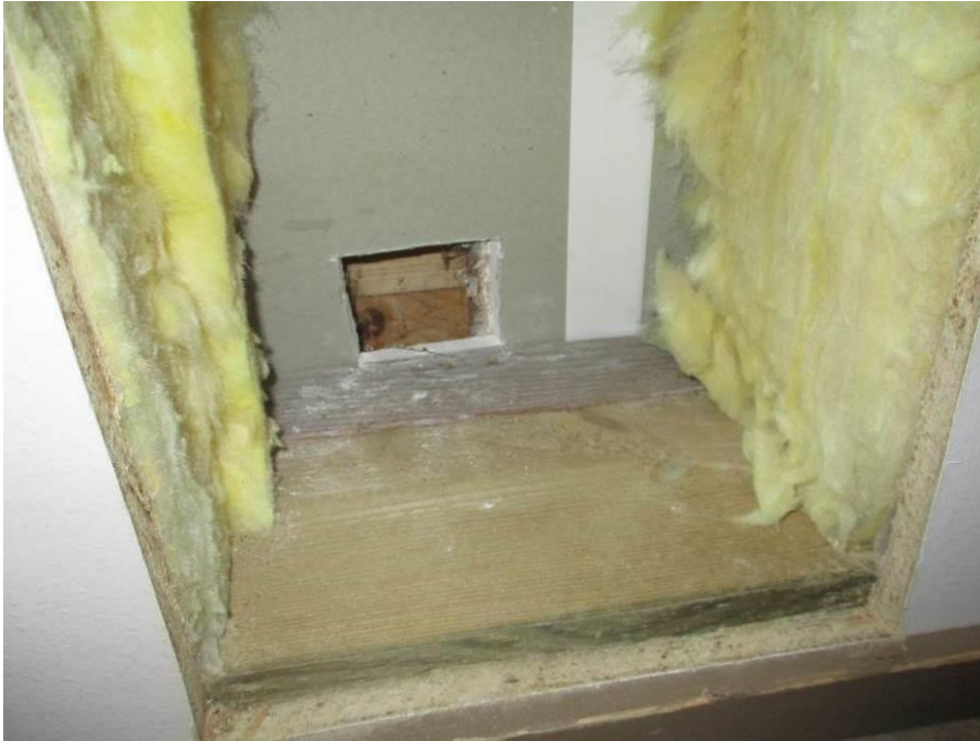
Kuva 59. Ulkoseinässä ei ole kosteusteknistä riskirakennetta.
