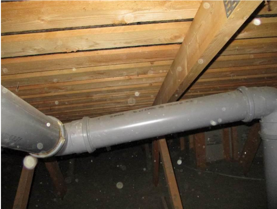
Kuva 161. Kaato viemärin tuuletusputkessa on väärään suuntaan ja putki kannakoimatta
