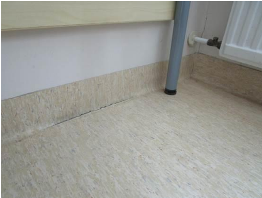
Kuva 102. Keittiö taustatila. Muovimatossa ratkeamia
