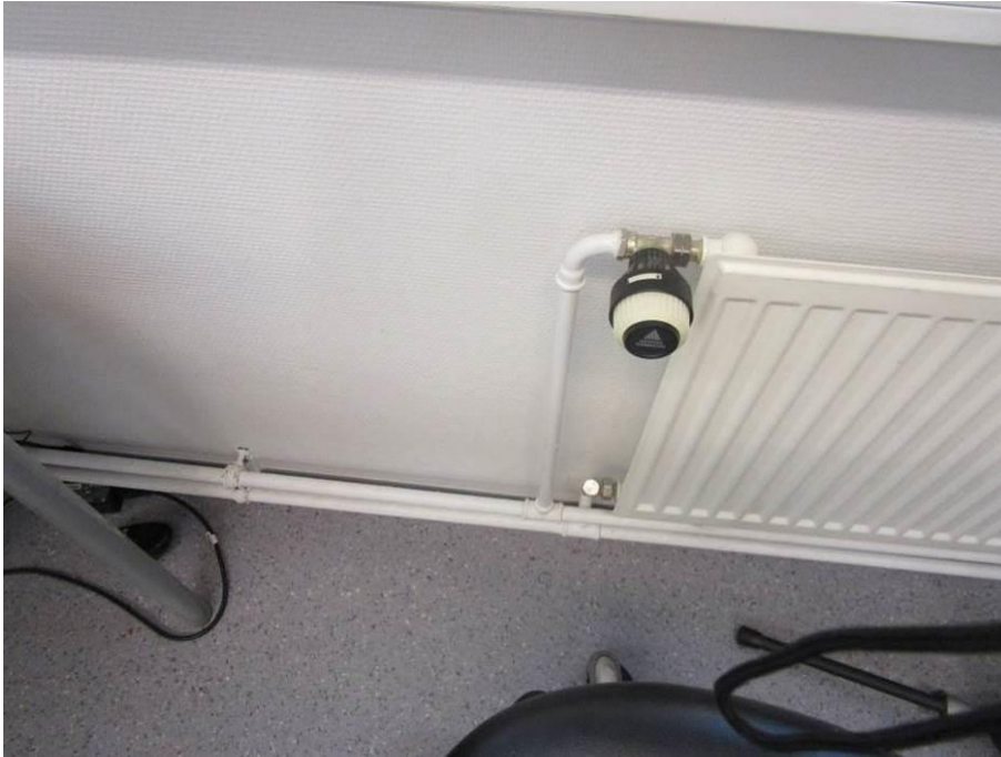
Kuva 156. Vanha patteriventtiili- ja termostaatti
