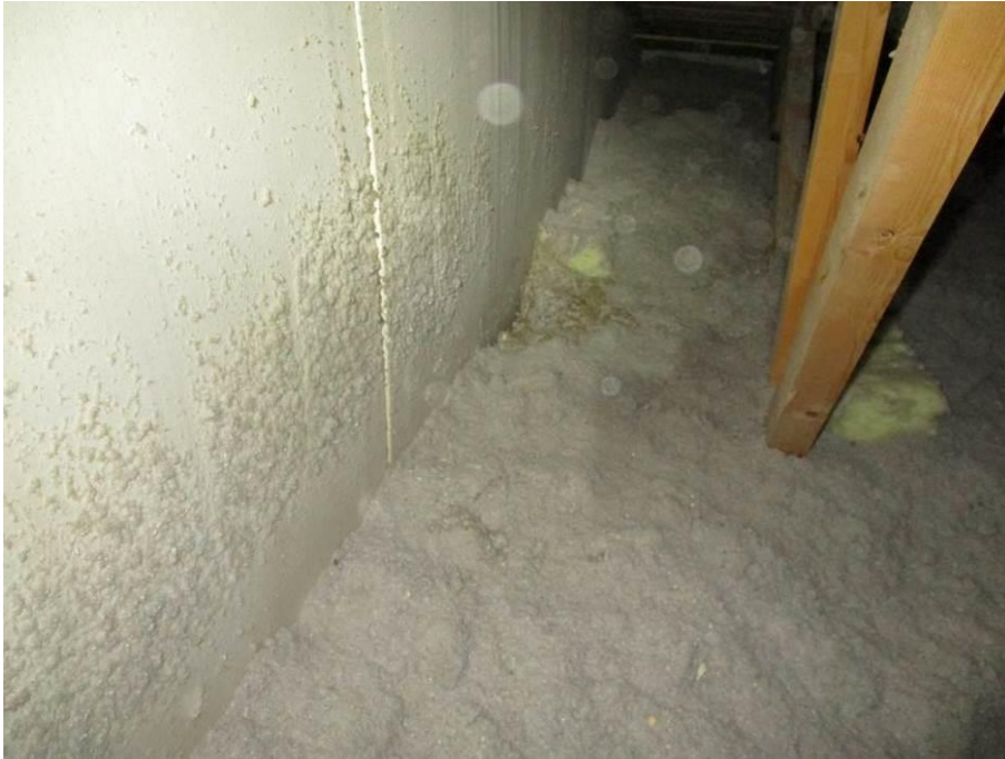
Kuva 83. Valumajälkiä vanhan ja uuden osan liittymässä.
