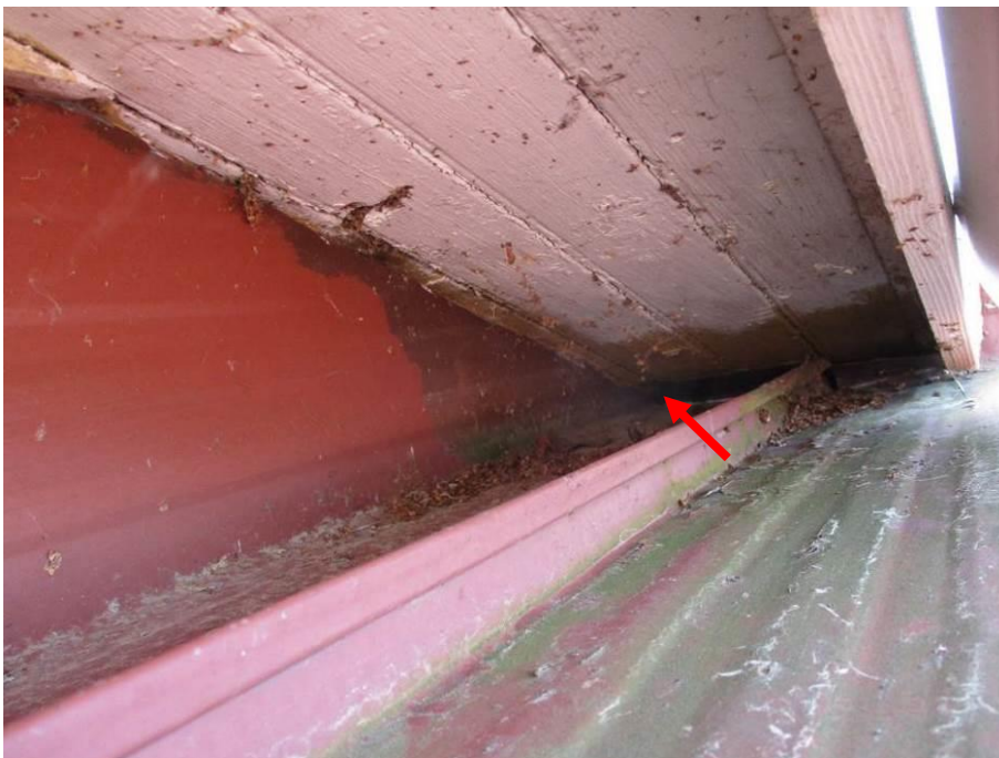
Kuva 73. Rästään alla katto on epätiivis.
