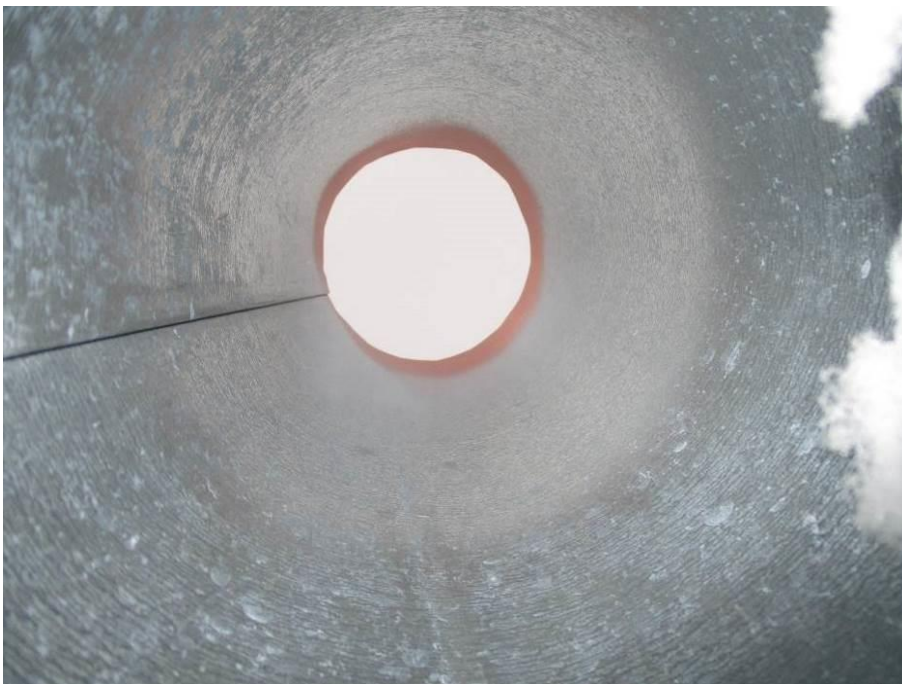
Kuva 80. Yläpohjan alipaineventtiilin päällä ei ole hattua.
