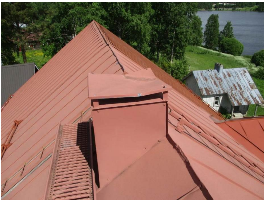
Kuva 69. Ilmanvaihtokotelon hattu on painunut kasaan.
