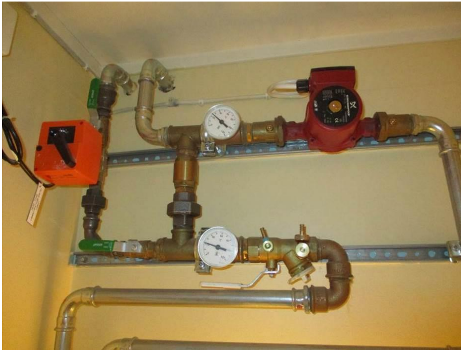
Kuva 151. Ilmanvaihtokoneen TK02 shunttiryhmä
