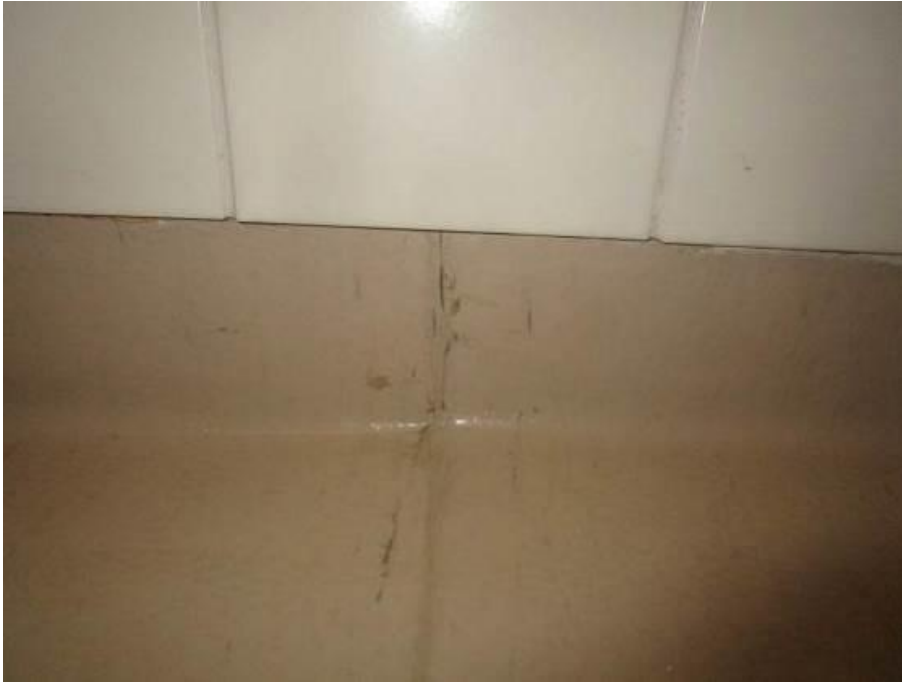
Kuva 127. Muovimaton sauma ratkennut
