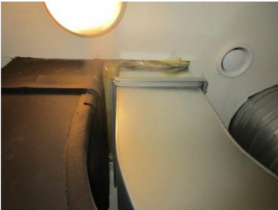
Kuva 114. IV-konehuone. Läpivientejä tiivistämättä
