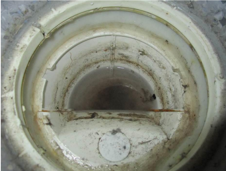
Kuva 159. Siivouskomeron lattiakaivo vuotaa
