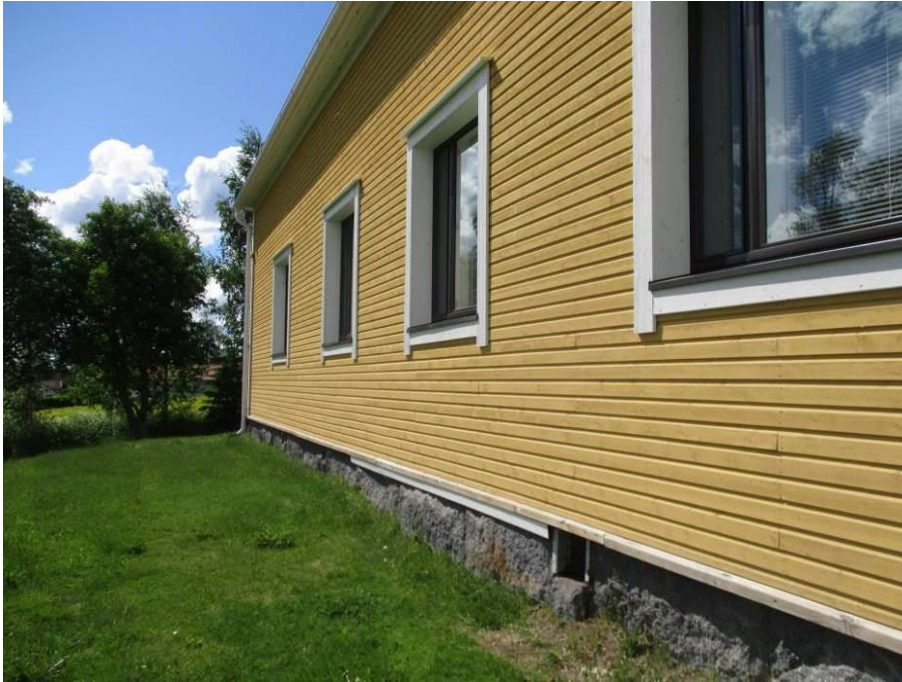
Kuva 23. Porakivi alkuperäisessä osassa.
