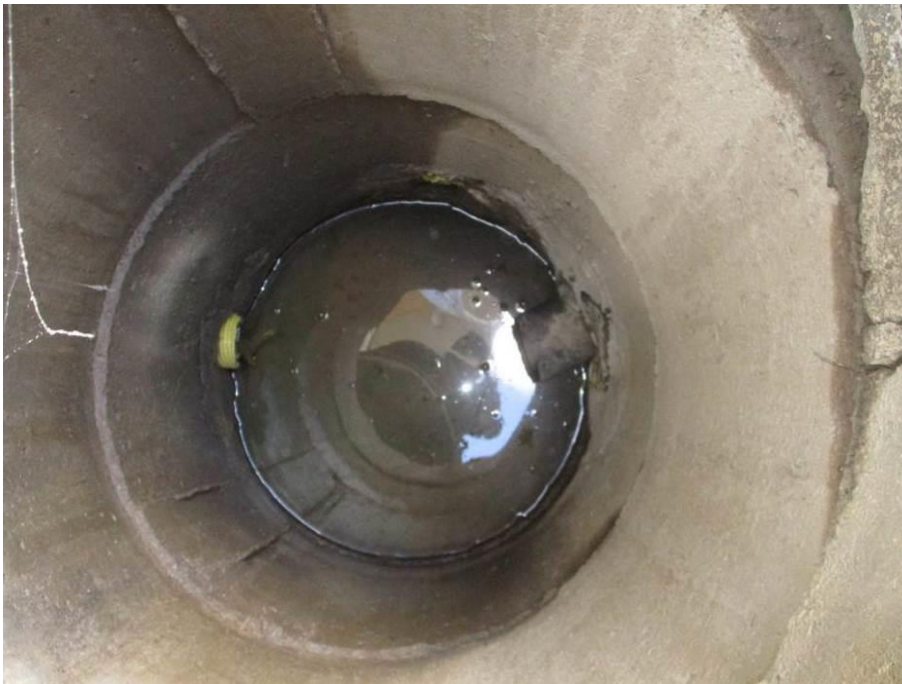
Kuva 17. Kaivossa on vettä.
