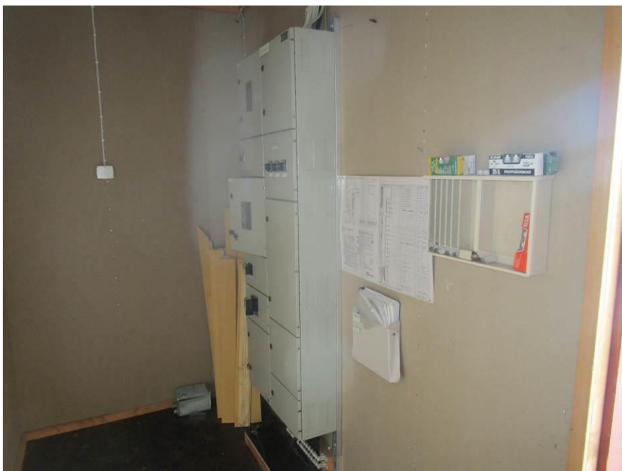
Kuva 177. Sähköpääkeskus ja mittarikeskus
