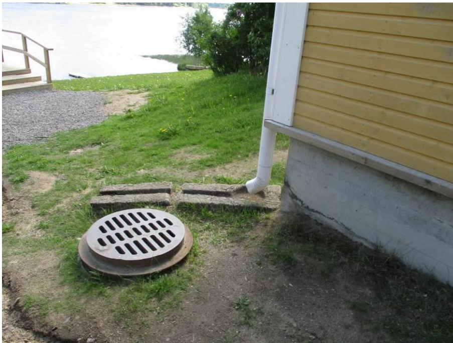
Kuva 18. Takanurkan salaojan tarkistuskaivo.
