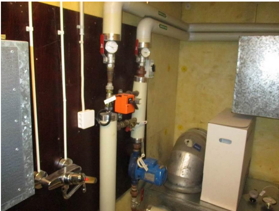
Kuva 150. Ilmanvaihtokoneen TK01 shunttiryhmä
