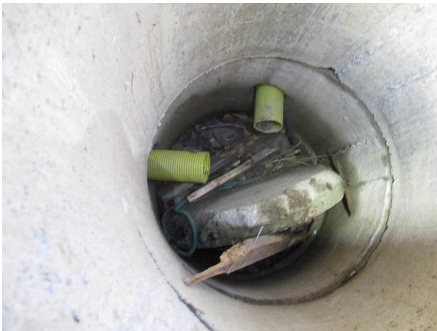
Kuva 19. Tarkistuskaivossa on roskaa eikä kaivossa ole vettä.
