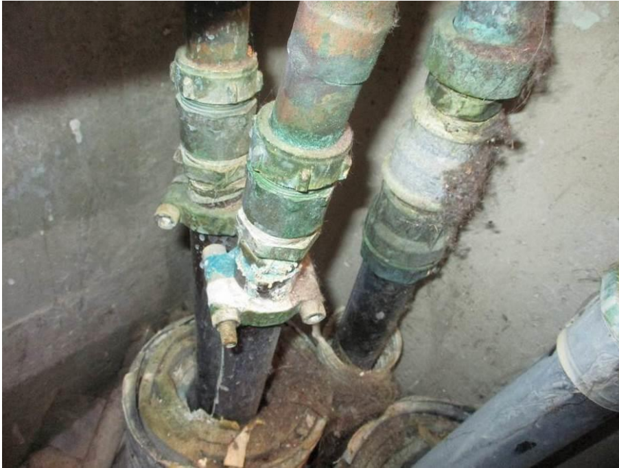
Kuva 157. Kupariputket hapettuneet pinnasta
