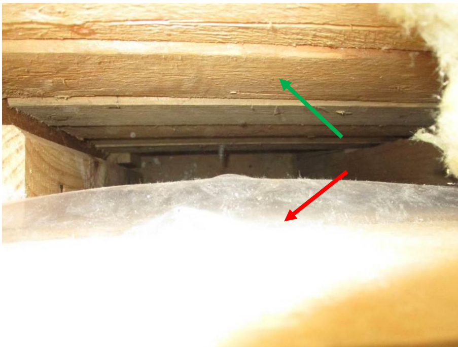
Kuva 94. Varaston yläpohjan muovia (punainen) ei ole limitetty salin ulkoseinään (vihreä).
