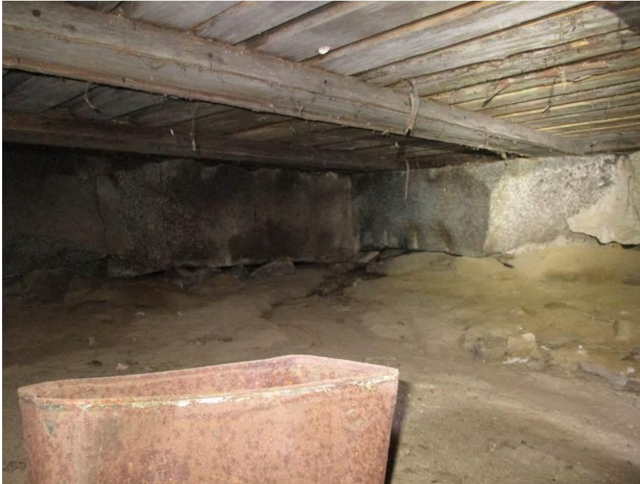
Kuva 28. Alapohjaan valuu pintavettä etupihan puolelta.
