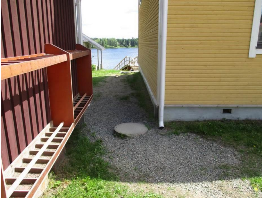
Kuva 16. Etunurkan salaojan tarkistuskaivo.
