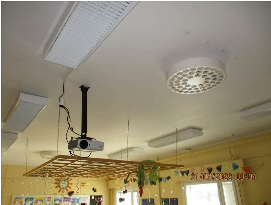
Kuva 174. Tuloilmapäätelaite luokkatilan katossa
