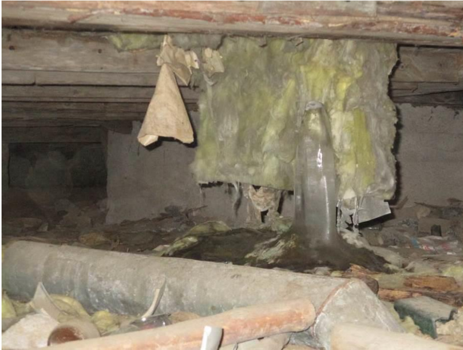
Kuva 34. Alapohjan eristeet pudonneet alas.
