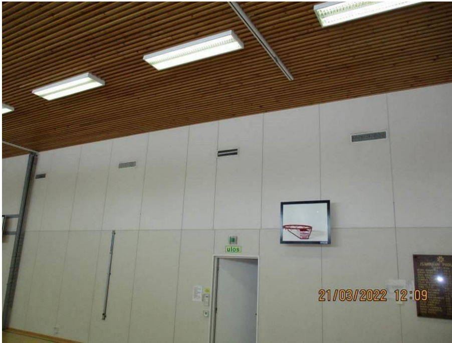
Kuva 171. Liikuntasalin tulo- ja poistoilmapäätelaitteita
