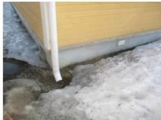
Kuva 4. Raskasmetalleja sisältävää sokkelimaalia.
