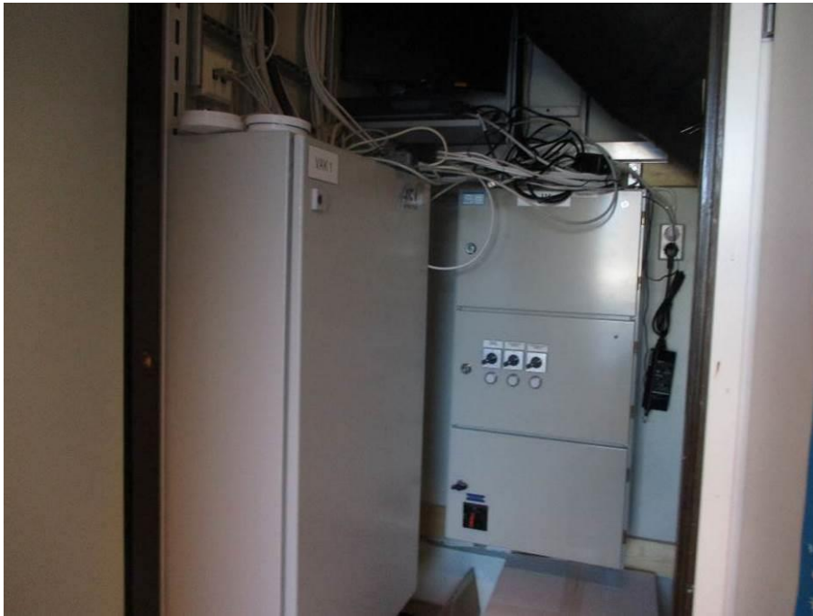
Kuva 181. Ilmanvaihtokoneen TK02 keskus
