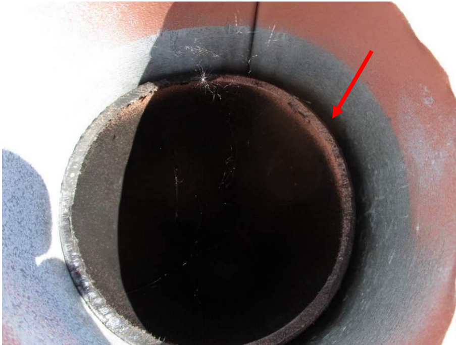
Kuva 70. Viemärin tuuletusputken ja kartion saumakohta on epätiivis.
