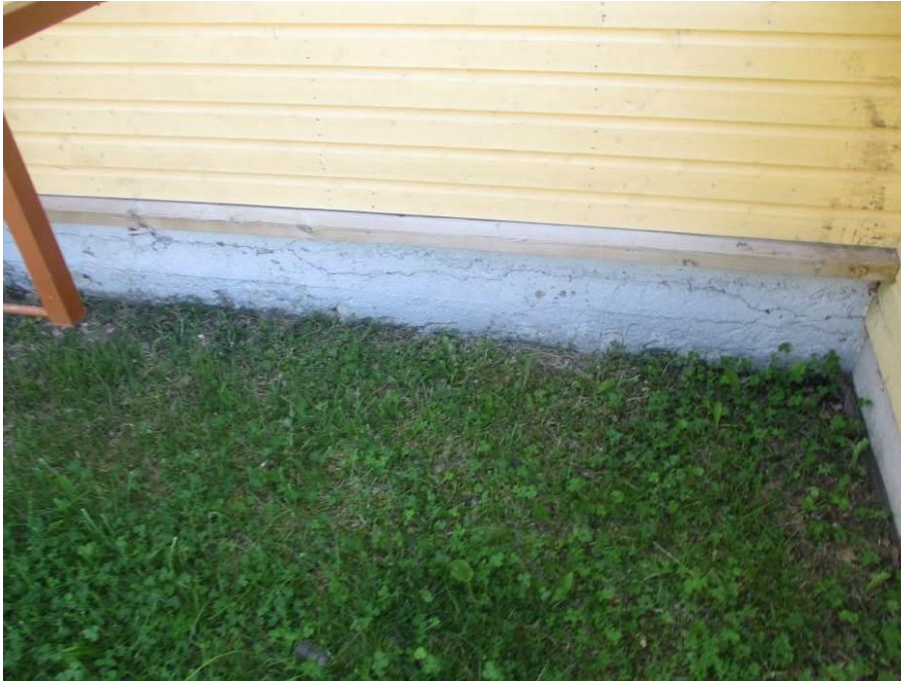
Kuva 22. Sokkelin pinta on hieman rapautunut.
