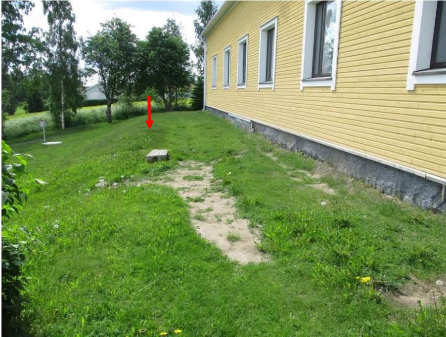
Kuva 2. Maanpinnan kaato on hieman puutteellinen.
