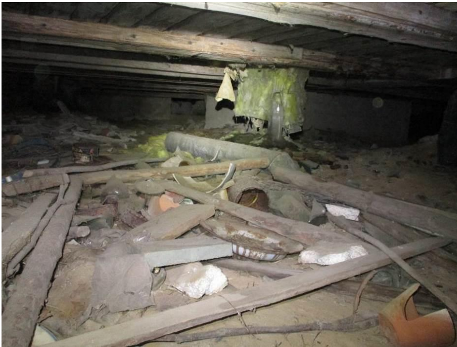
Kuva 27. Alapohjassa runsaasti roskaa.
