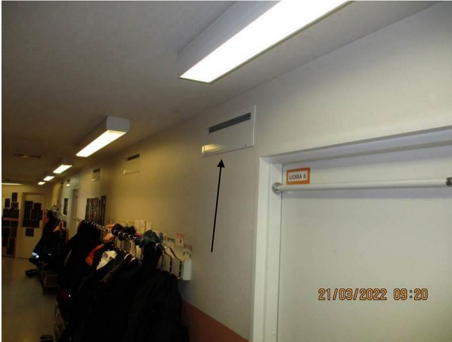
Kuva 175. Siirtoilmasäleikkö luokkatilasta käytävälle
