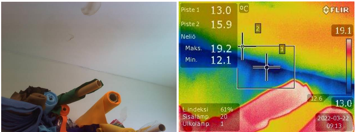
Kuva 82. Ilmavuotoa vanhan osan ja laajennuksen saumakohtasta.
