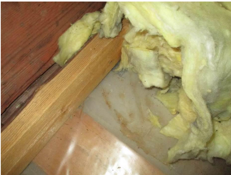
Kuva 84. Muovin päällä on veden aiheuttamia jälkiä.
