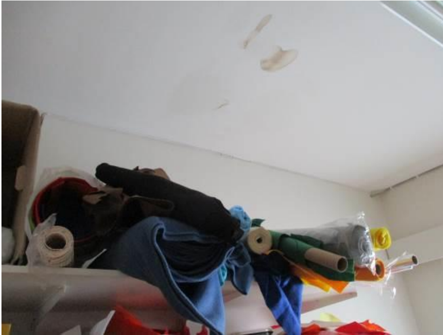
Kuva 137. Opetusvälinevarasto, katossa vuotojälkiä
