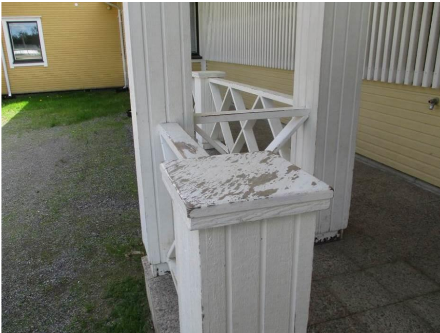
Kuva 11. Puuosien maalipinta on kulunut.
