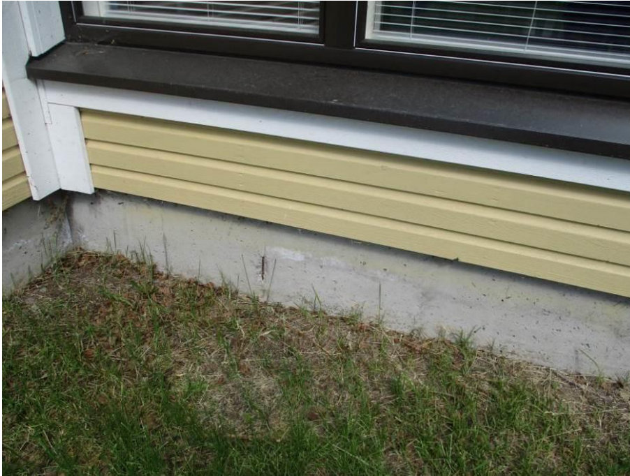
Kuva 25. Sokkelin hakasteräkset ovat ruostuneet rikkoen sokkelin pintaa.
