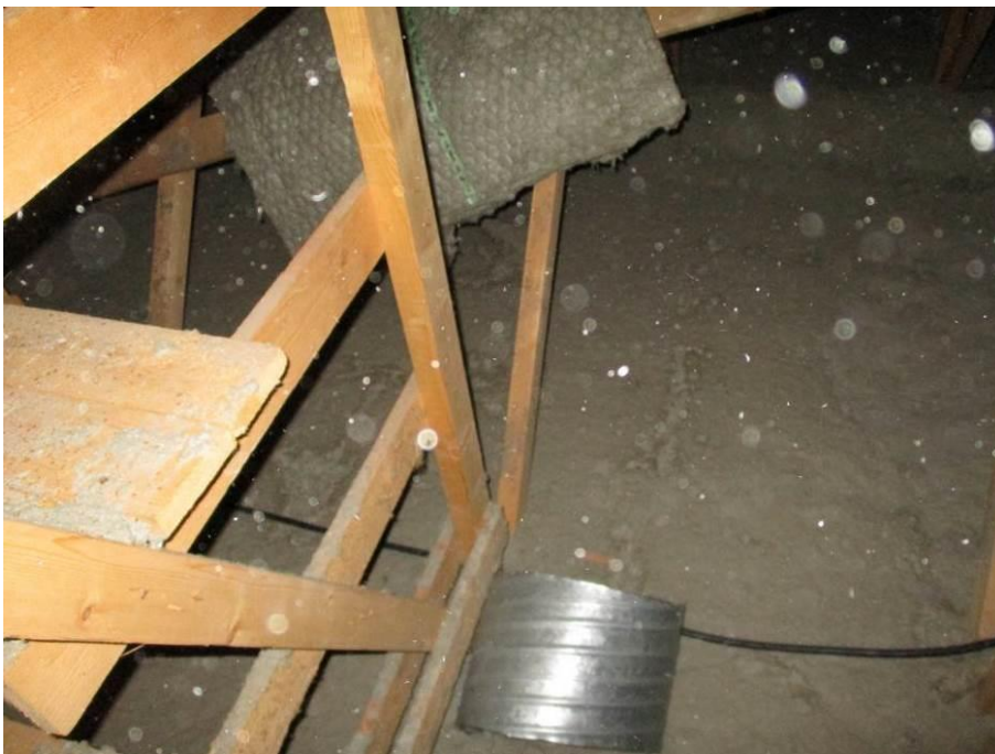
Kuva 88. Yläpohjan eristyksessä runsaasti kosteuden aiheuttamia jälkiä.
