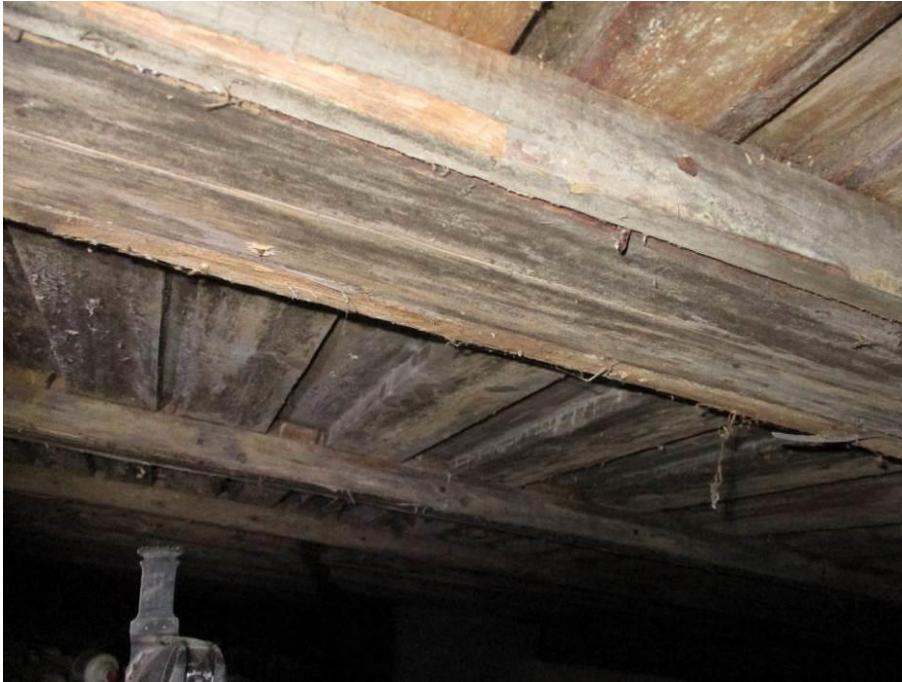
Kuva 30. Alapohjan palkissa värimuutoksia.
