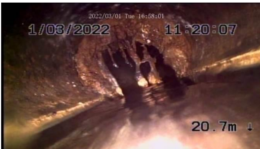
Kuva 164. Kuvaus 1. irronnut muhviiliitoksen tiiviste. Kohta piha-alueella lähellä kaivoa.
