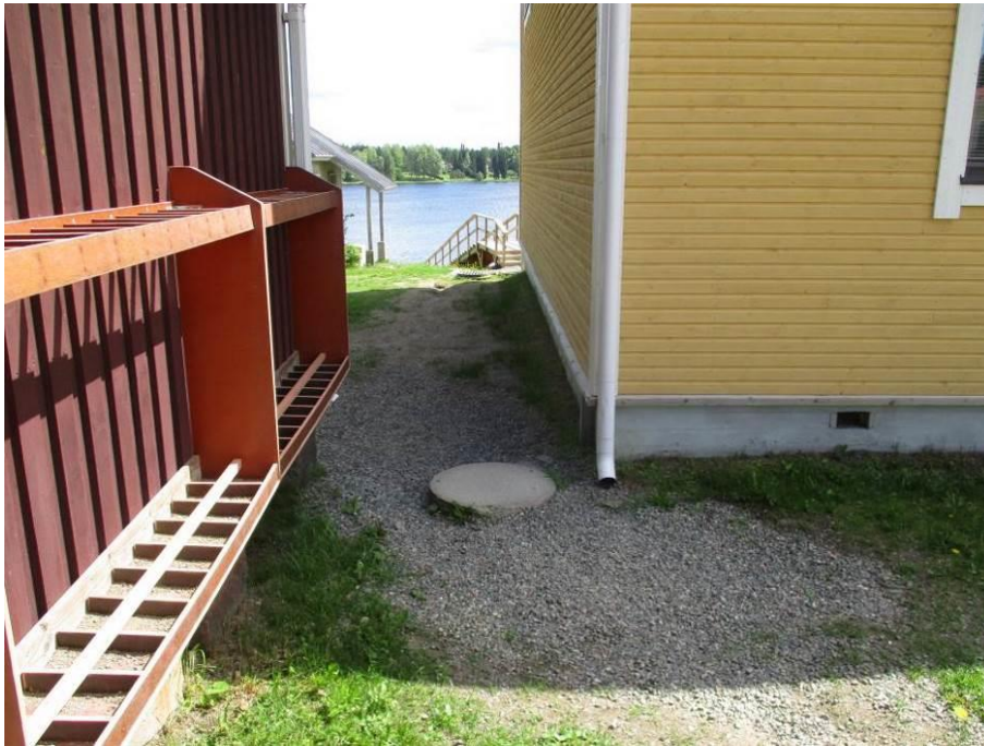
Kuva 14. Etunurkan kattovedet johdetaan rakennuksen vierustalle.
