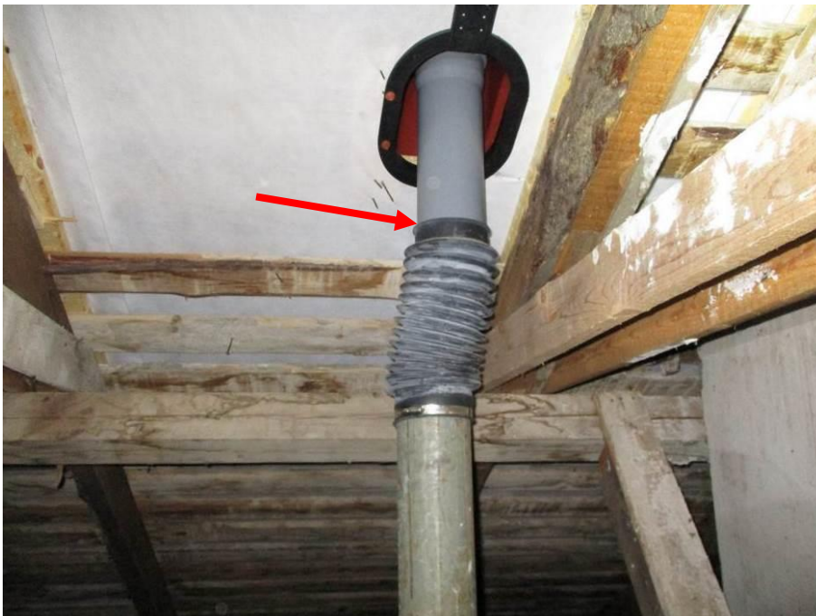
Kuva 70. Viemärin tuuletusputki eristämättä ja putkesta puuttuu kiristyspanta.
