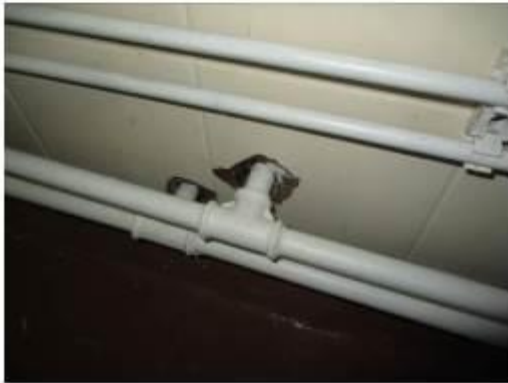
Kuva 3. Yläkerran vessan seinän kovalevyn takana asbestipitoinen pikiliima.
