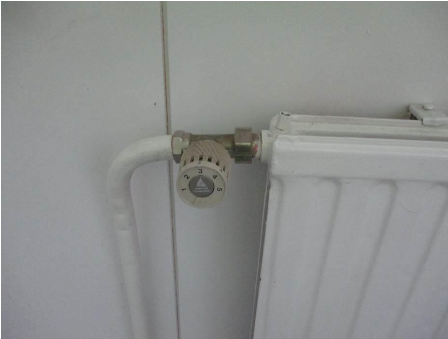
Kuva 136. Vanhan osan lämmityspatteri ja termostaatti
