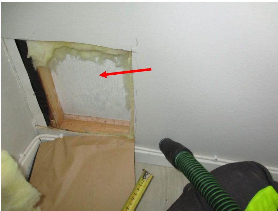
Kuva 43. Alkuperäisessä rakenteessa on tapetti paikoillaan.
