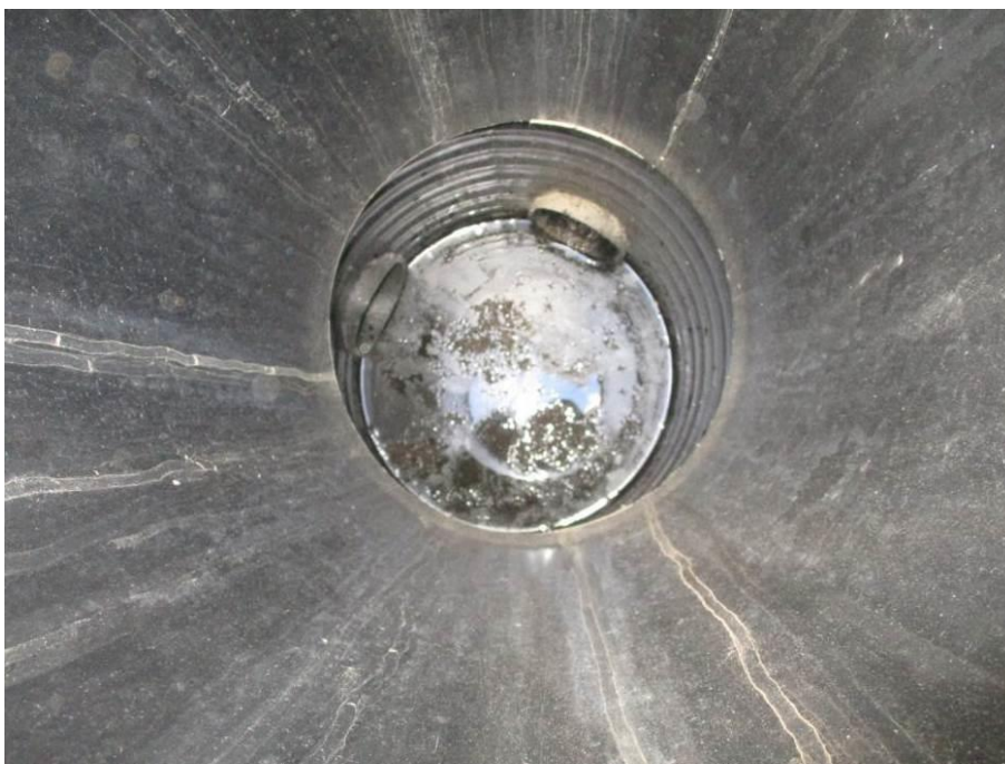
Kuva 14. Salaojakaivossa putkistot ovat vedenpinnan yläpuolella.
