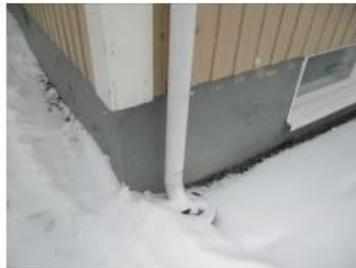
Kuva 10. Raskasmetalleja sisältävä sokkelimaali.
