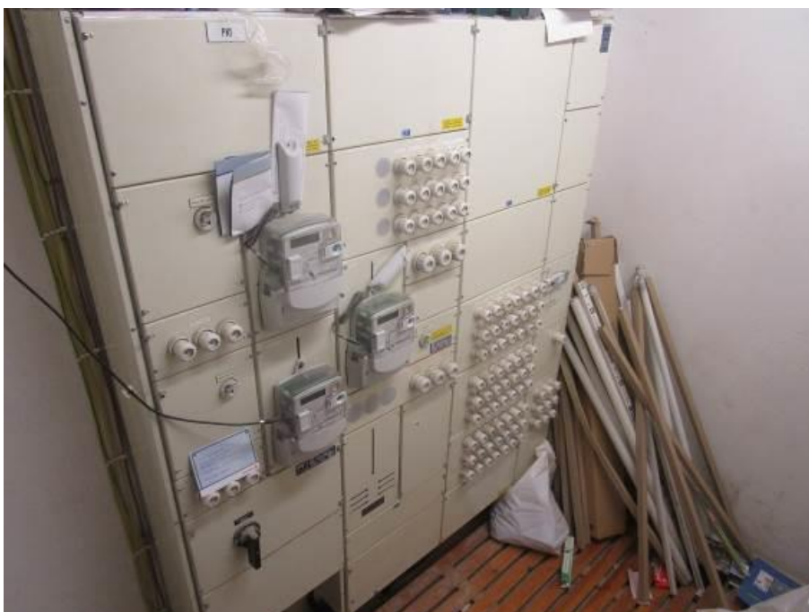
Kuva 158. Sähköpääkeskus ja mittarikeskus
