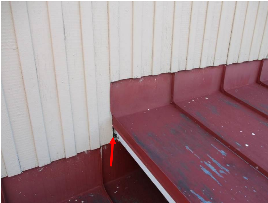
Kuva 60. Reunapelti on hieman epätiivis.
