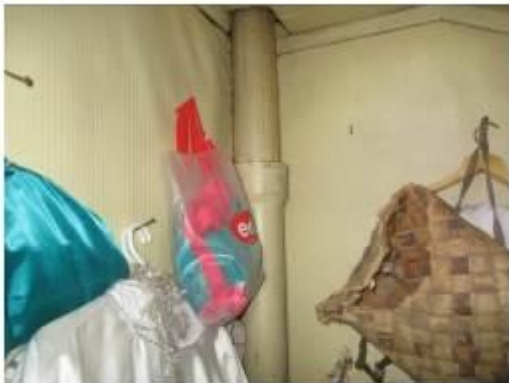
Kuva 11. Lyijyä sisältävät viemäriputkitiivisteet.
