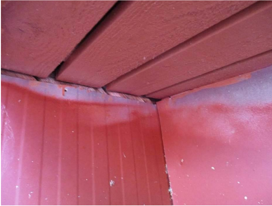
Kuva 61. Räystään alusrakenne on hieman epätiivis.
