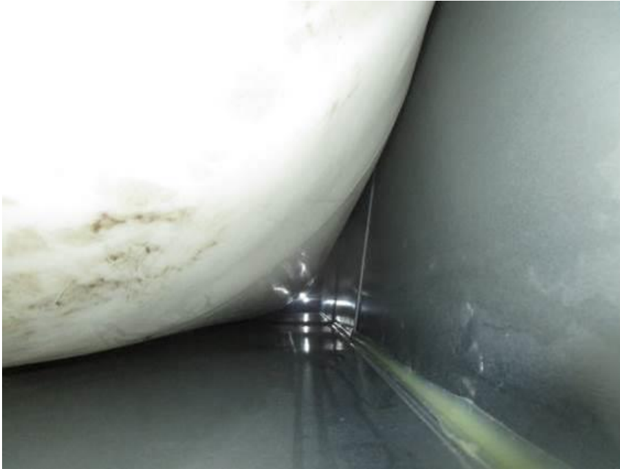
Kuva 132. Öljysäiliön valuma-altaassa polttoainetta
