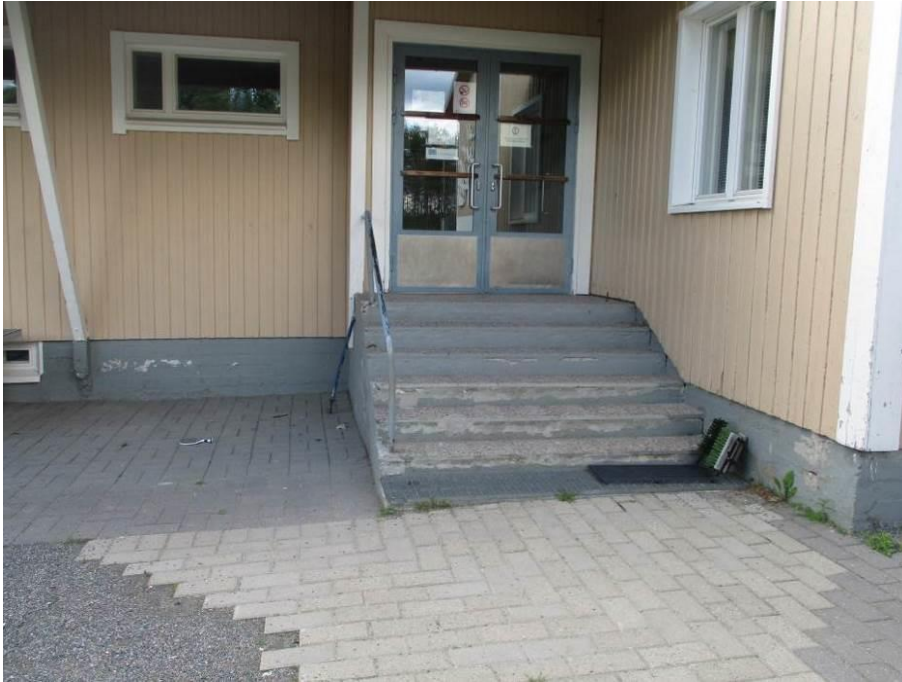
Kuva 10. Portaikon maalipinta on heikossa kunnossa.
