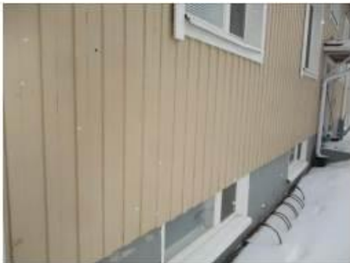
Kuva 9. Lyijyä sisältävä ulkoseinämaaali.
