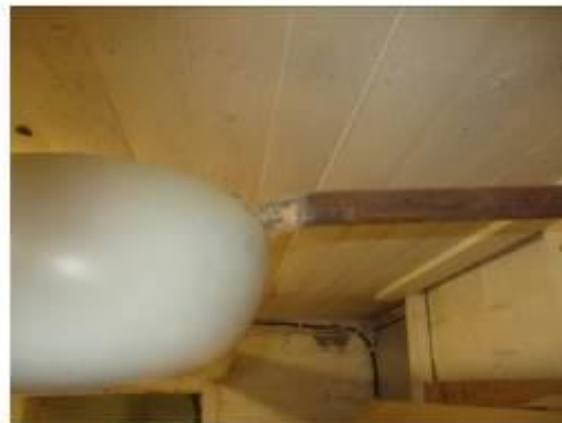
Kuva 6. Asbestipitoisen putkieristeen jäämiä.
