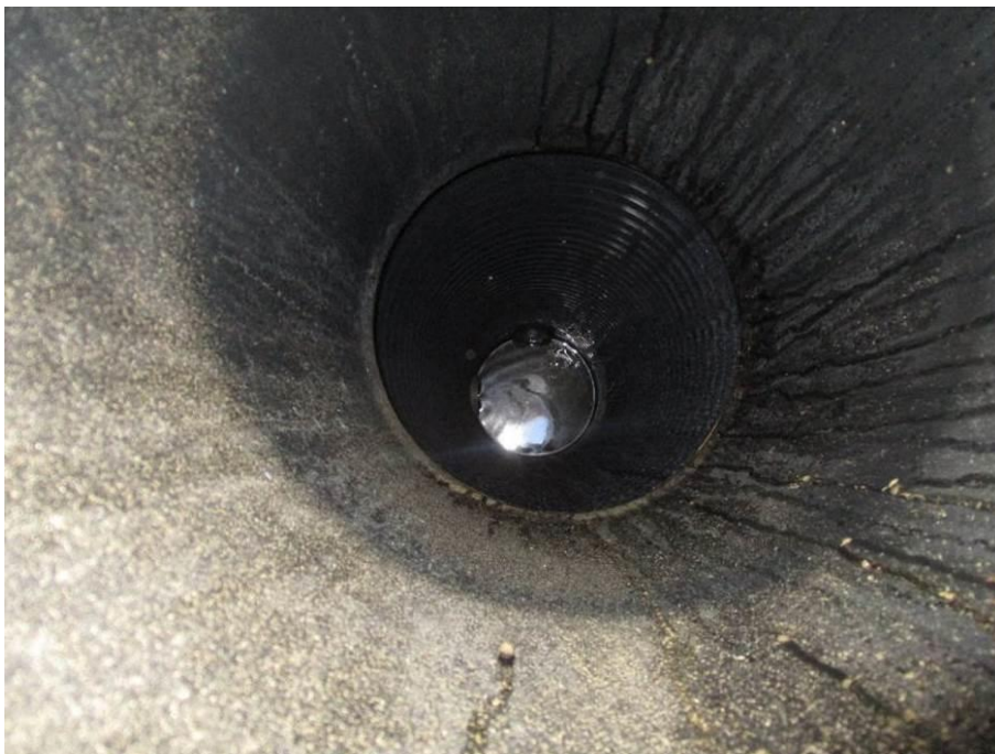
Kuva 16. Vedenpinta putkiston alapuolella.
