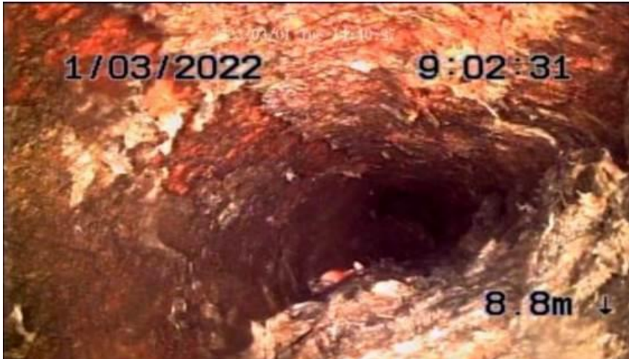
Kuva 141. Kuvaus 1. pohjaviemäri tukkeutunut
