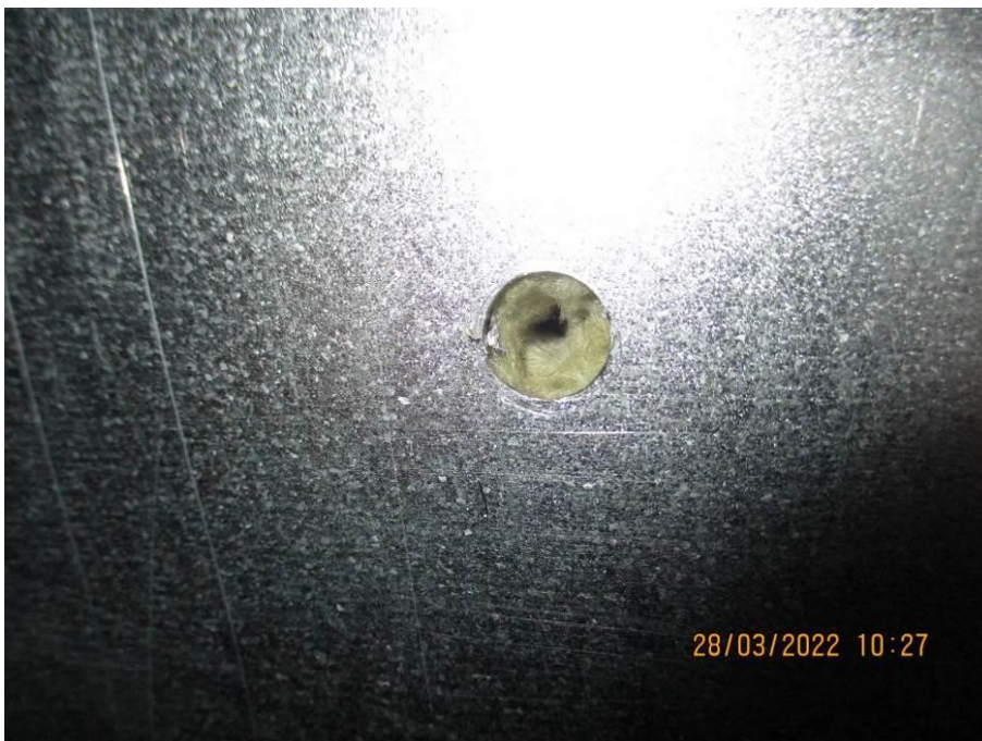
Kuva 157. Tuloilmakammiossa ääneneristemateriaalina villaa
