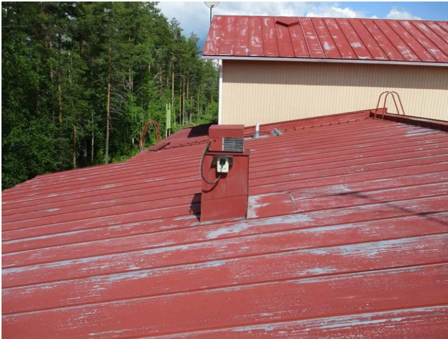
Kuva 62. Maalipinta on kulunut.
