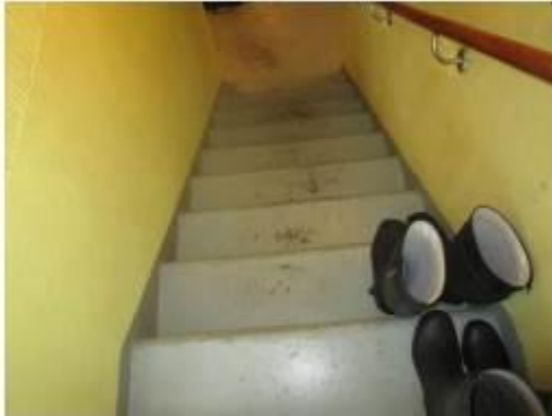
Kuva 1. Asbestipitoinen harmaa lattiamali.
