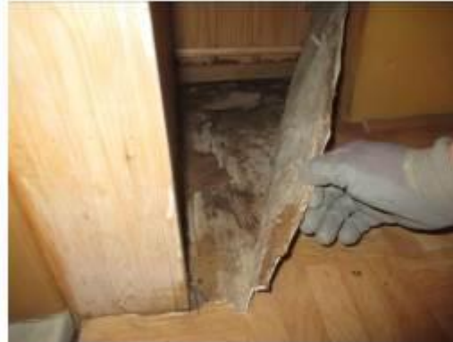
Kuva 2. Kellarin pukuhuoneen lattiassa asbestipitoinen pikiliima.
