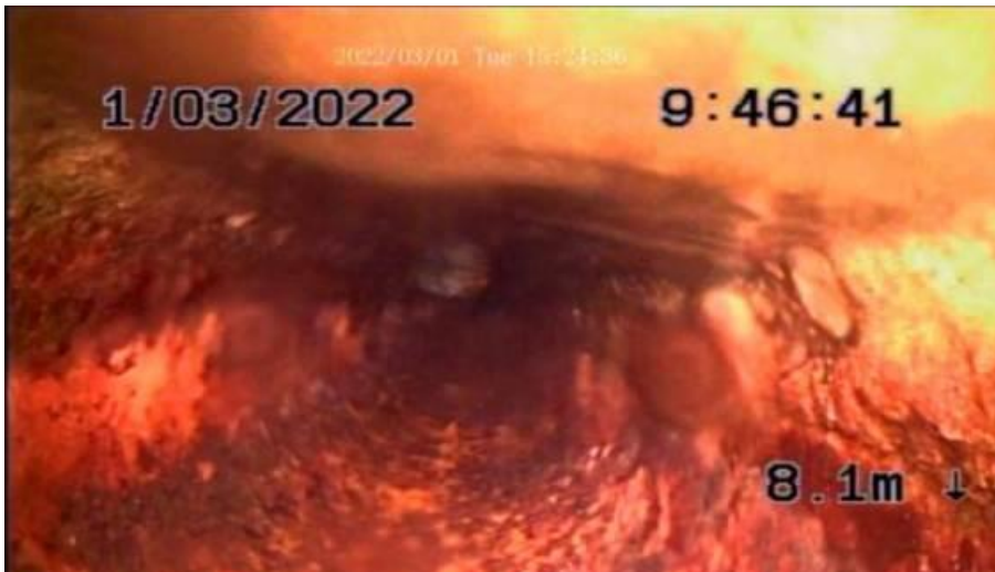
Kuva 145. Kuvaus 5. liitos muoviviemäriin ennen pihakaivoa. Valurautainen putki osittain tukkeutunut
