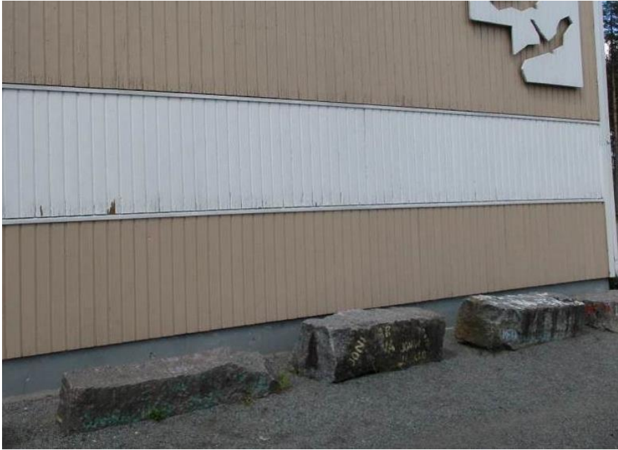
Kuva 46. Julkisivu on heikossa kunnossa.
