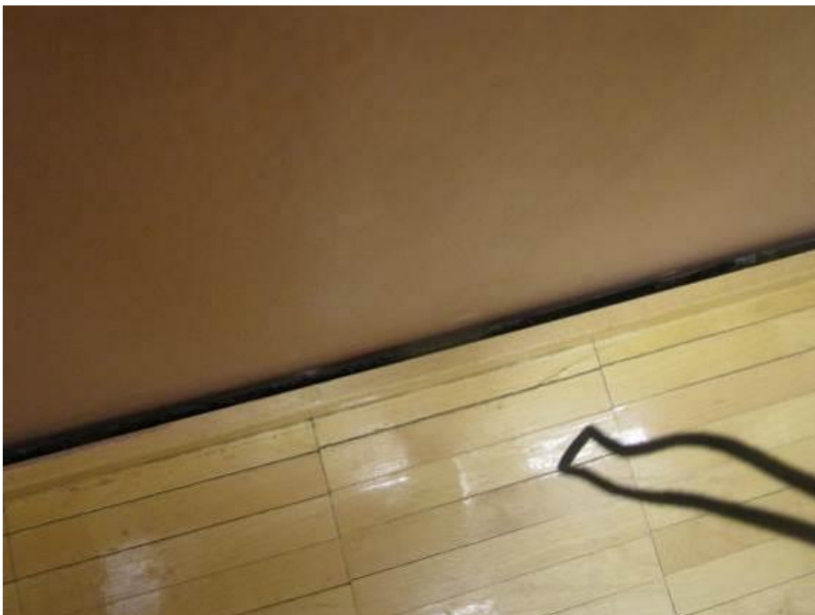
Kuva 72. Seinän ja lattian liitossaumassa rako
