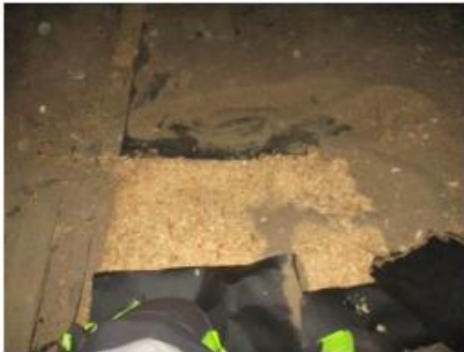
Kuva 13. PAH-yhdisteitä sisältävää tervapaperia yläpohjassa.
