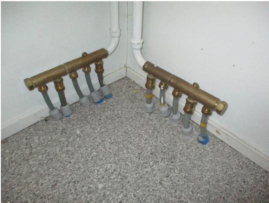
Kuva 135. Liikuntasalin lämmitysputkistojen jakotukkeja
