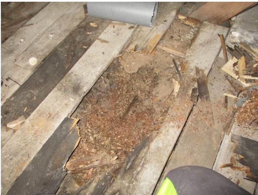
Kuva 68. Korjaamaton kosteusvaurio yläpohjassa.
