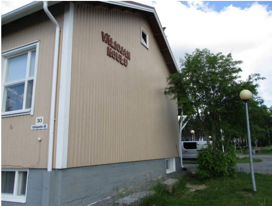
Kuva 18. Sokkelin maalipinta on irti alustastaan.
