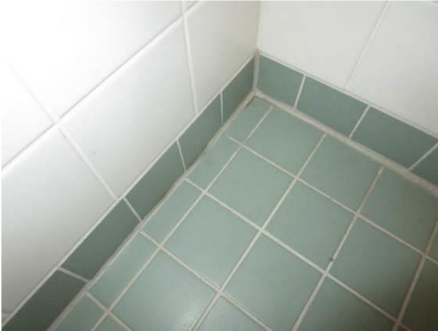
Kuva 81. Tyttöjen pesuhuoneen silikonisaumoissa ratkeamaa.
