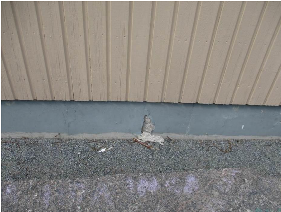
Kuva 17. Liikuntasalin sokkelissa korroosion aiheuttamia rapautumia.
