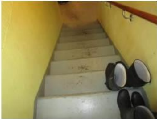
Kuva 7. Lyijyä sisältävä harmaa lattiamaaali.
