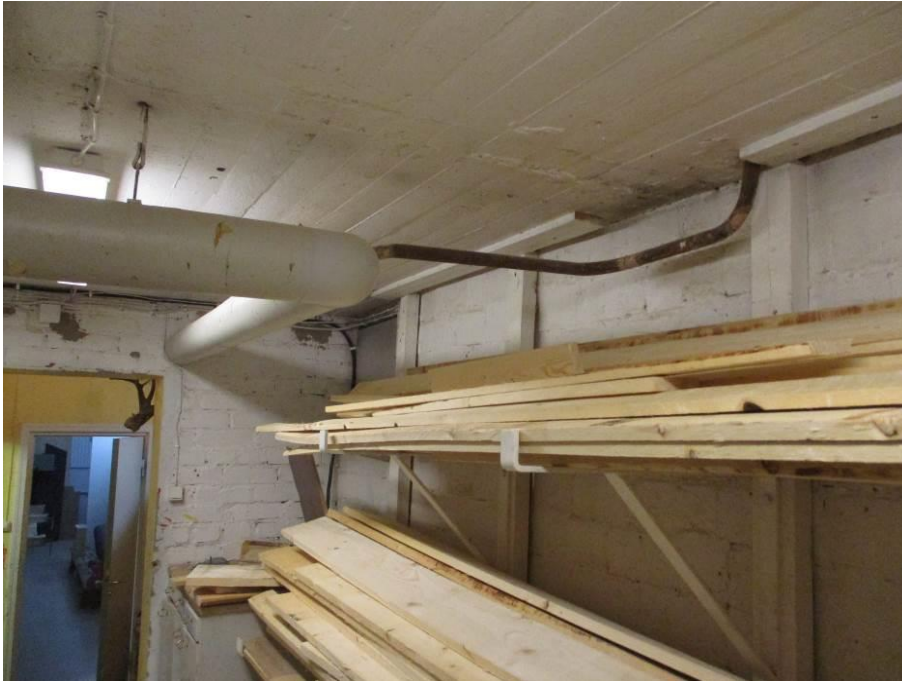
Kuva 134. Vanhan osan lämpöputkistoja
