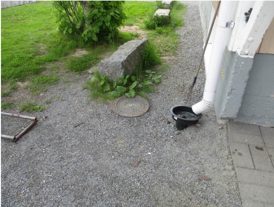
Kuva 12. Kattovedet ovat johdettu rännikaivoon.
