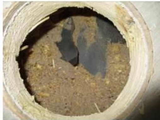
Kuva 12. PAH-yhdisteitä sisältävää tervapaperia välipohjassa.
