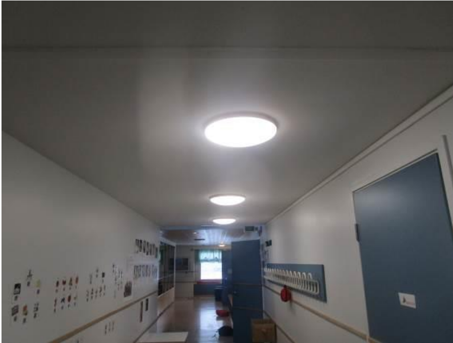
Kuva 164. Laajennusosan käytävän valaistuksia
