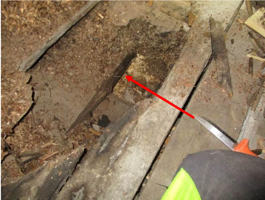
Kuva 69. Vaurioita purueristeessä ja puurakenteessa.
