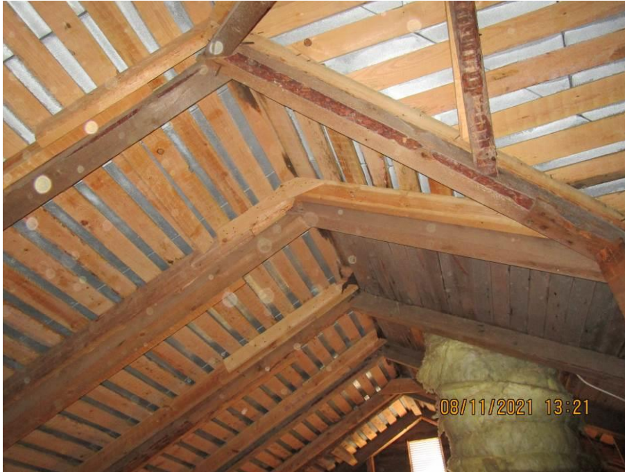
Kuva 42. Kosteusjälkiä harjan kohdalla.
