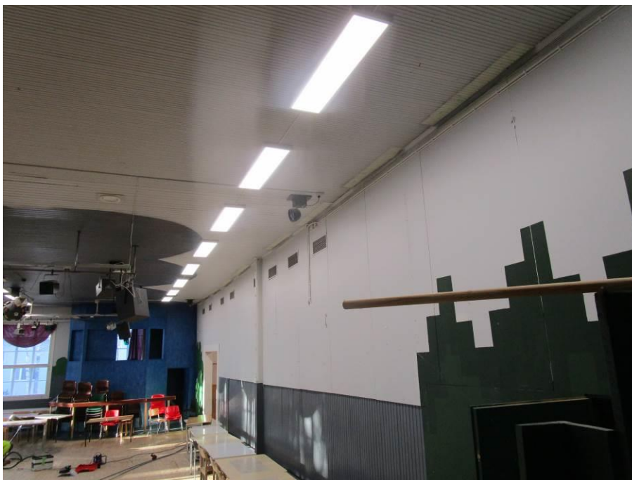
Kuva 65. Salin seinällä olevia tuloilmasáleiköitä
