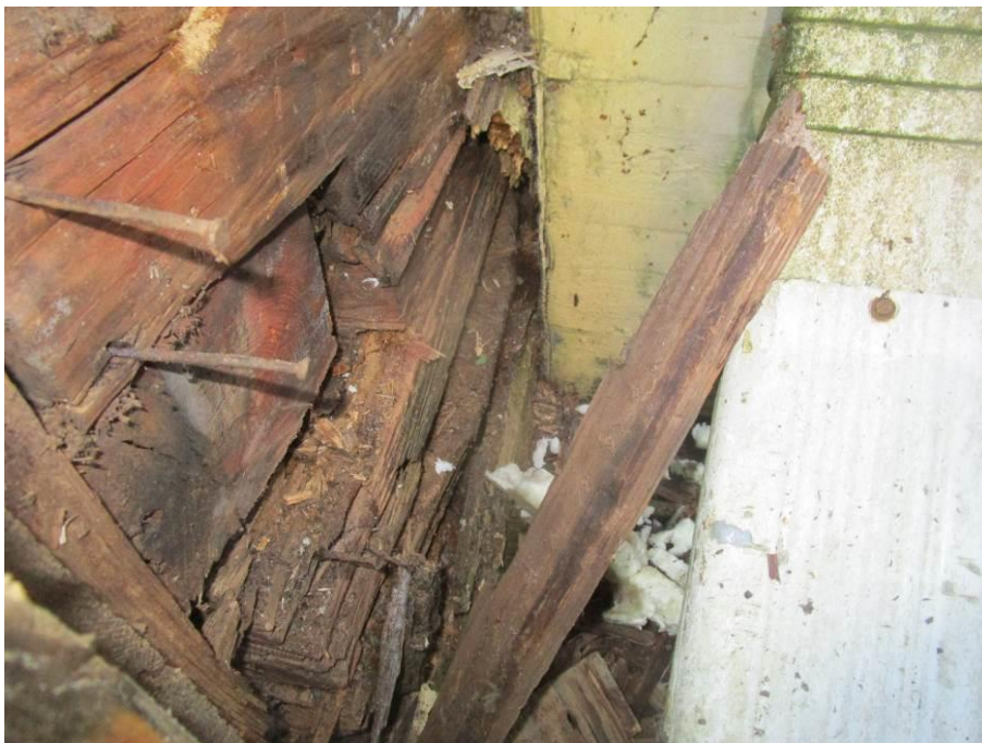
Kuva 30. Alimmissa hirsissä on laajoja lahovaurioita.
