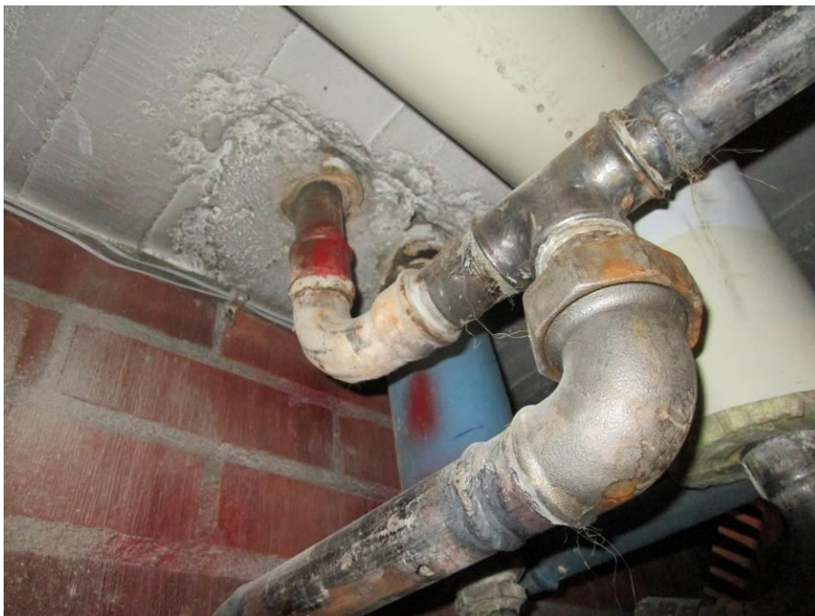
Kuva 53. 2. kerrokseen meneviä lämmitysputkistoja
