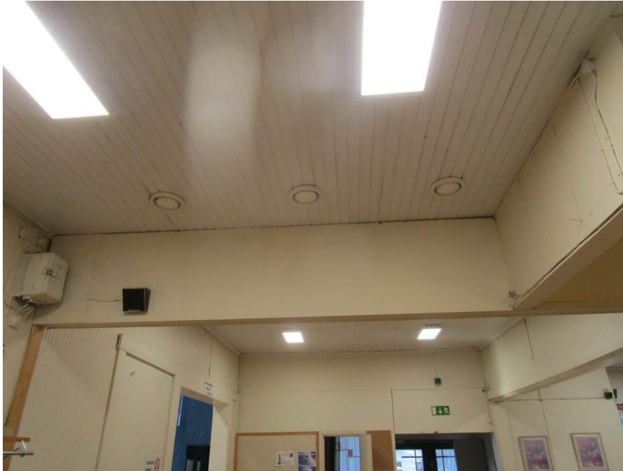
Kuva 66. Eteistilan katossa olevia poistoilmaventtiileitä
