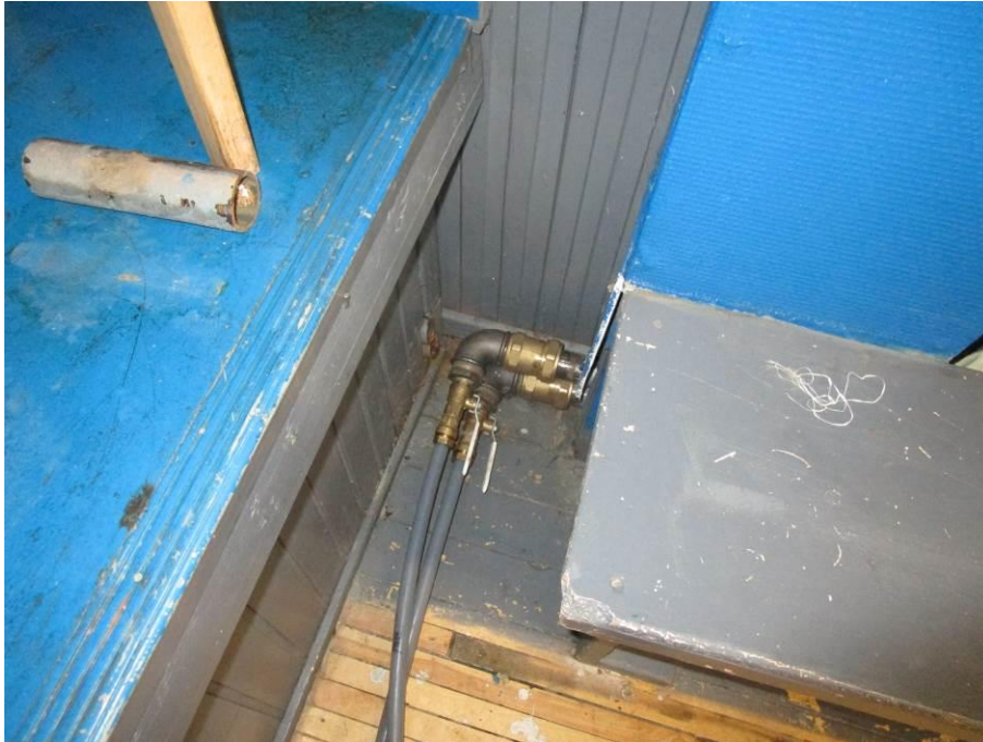
Kuva 52. Alkuperäiseen osaan meneviä lämmitysputkistoja
