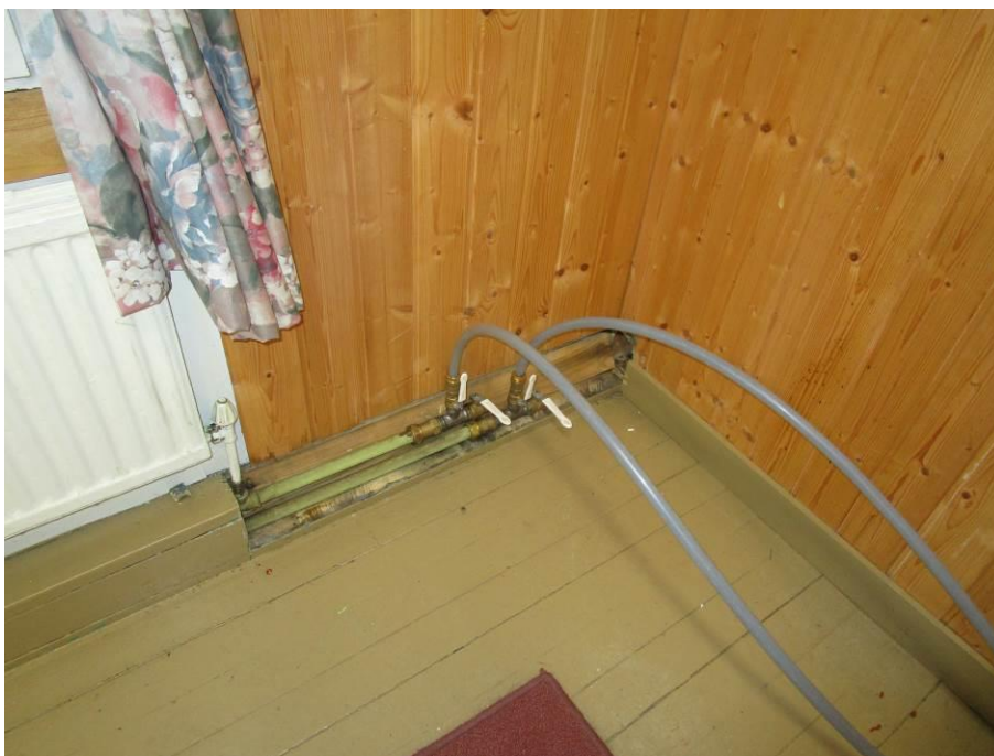
Kuva 51. Alkuperäiseen osaan meneviä lämmitysputkistoja
