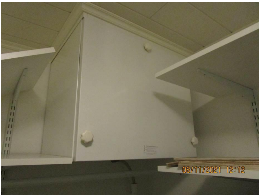
Kuva 59. Laajennusosan (asunto) ilmanvaihtokone
