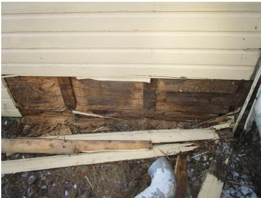
Kuva 32. Hirren pinnassa lahovaurioita.
