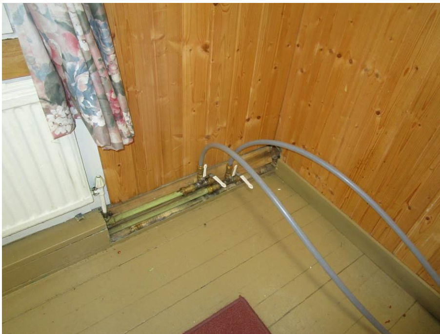
Kuva 51. Alkuperäiseen osaan meneviä lämmitysputkistoja
