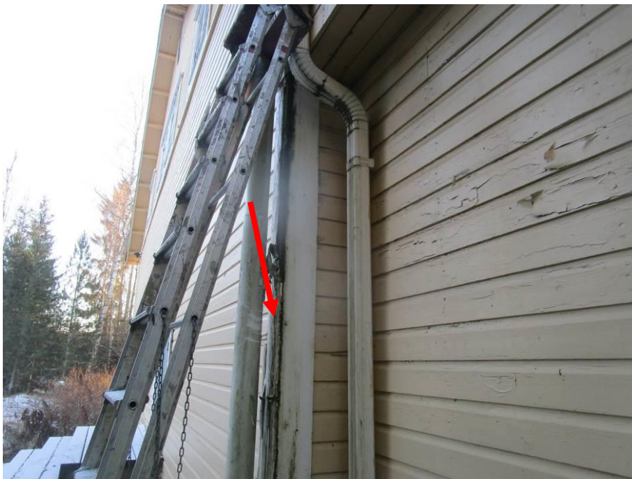
Kuva 28. Nurkkalaudoitus on vaurioitunut vanhan ja uuden liittymästä.
