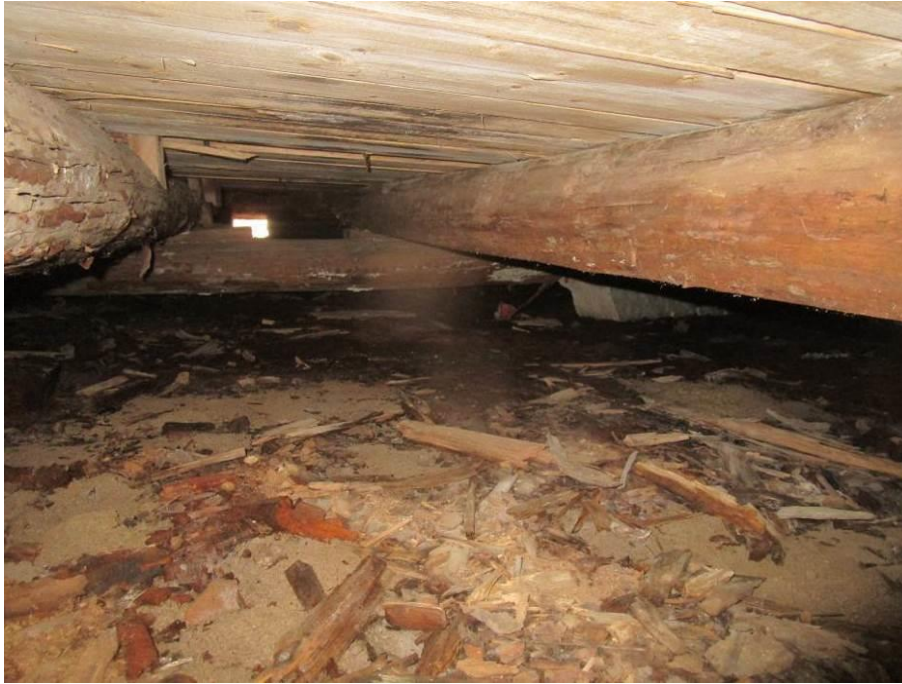
Kuva 5. Kantavissa palkeissa rihmastoa ja lahovaurioita.
