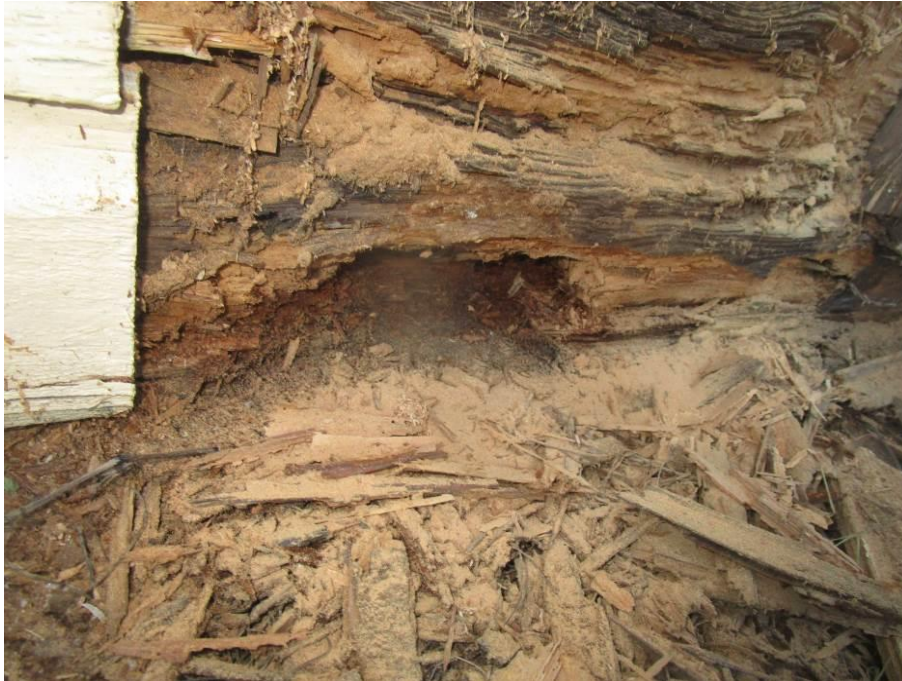
Kuva 33. Alimmassa hirressä lahovaurioita.
