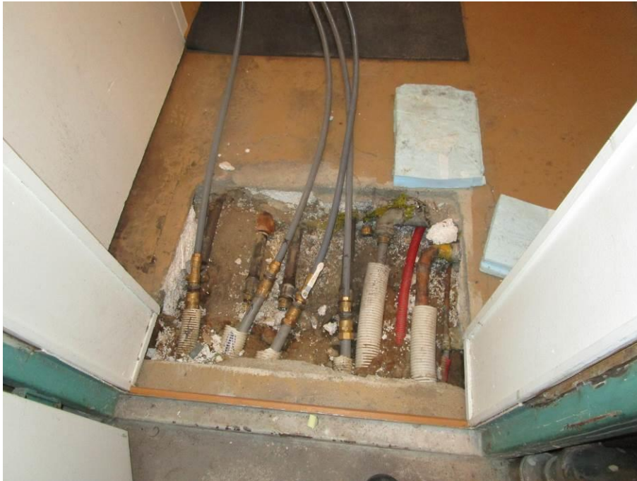
Kuva 50. Alkuperäiseen osaan meneviä lämmitysputkistoja
