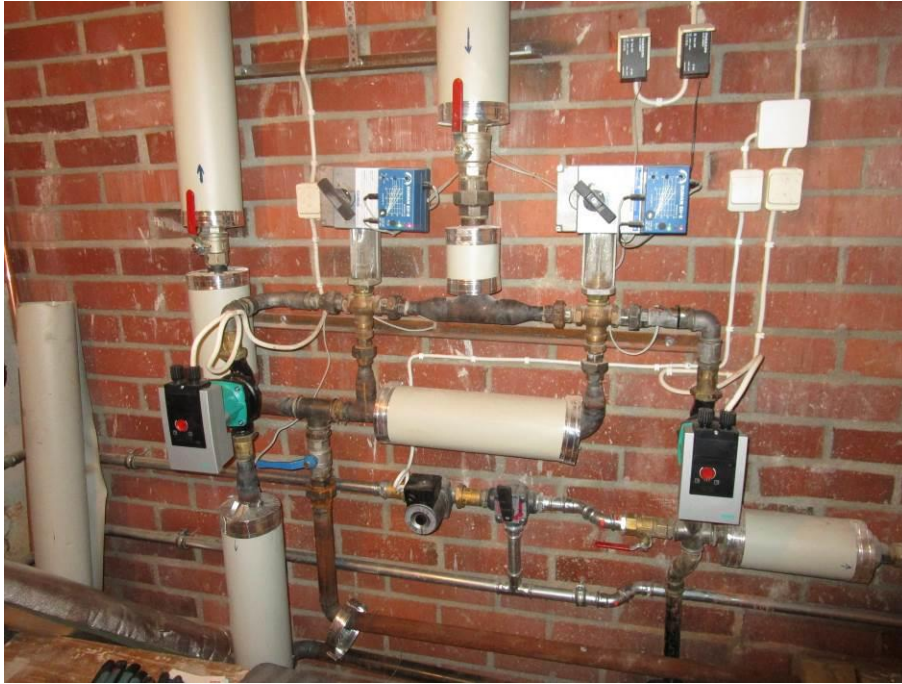
Kuva 46. Kiertovesipumppuja ja säätimiä
