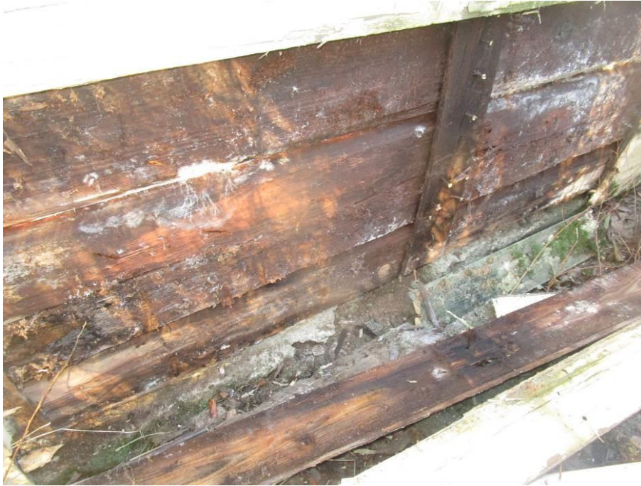
Kuva 26. Hirren pinnassa rihmastoa ja lahovaurioita.
