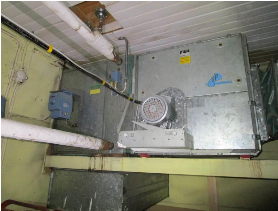
Kuva 60. Alkuperäisen osan tuloilmakone
