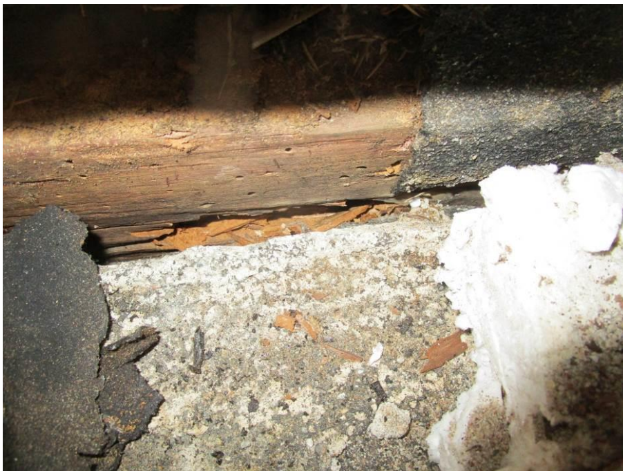
Kuva 36. Hirren sisäpinnassa lahovaurioita.
