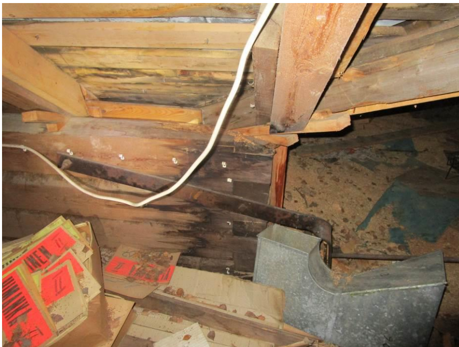
Kuva 43. Jiirin pohjassa vanhoja vuotoja.
