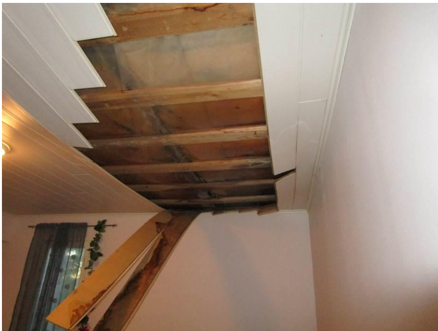
Kuva 39. Vettä yläpohjan höyrynsulkumuovin päällä.
