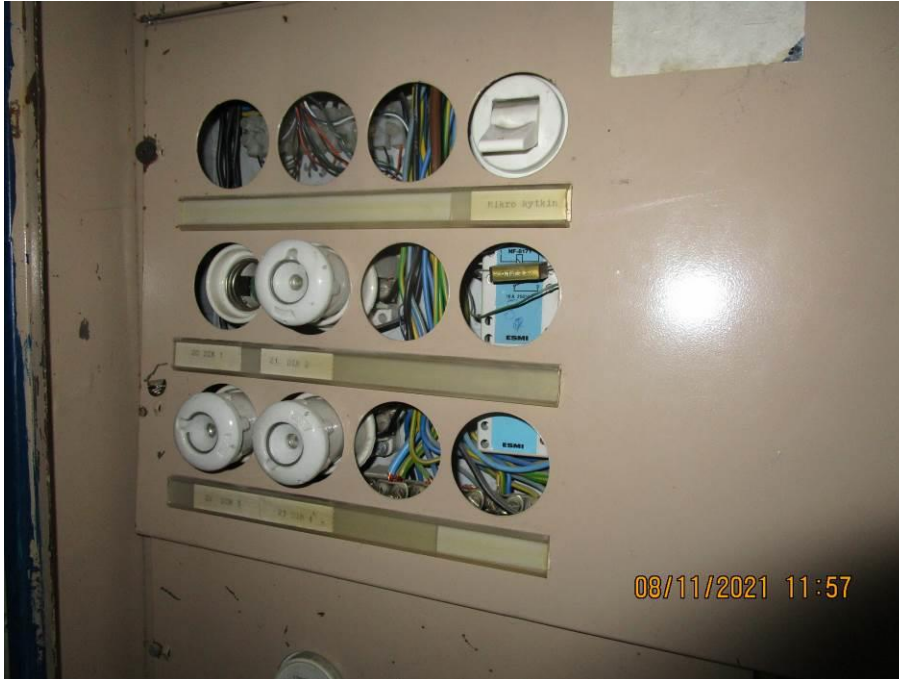
Kuva 71. DJ-kopin keskuksessa suojaamattomia sulakekansiaukkoja
