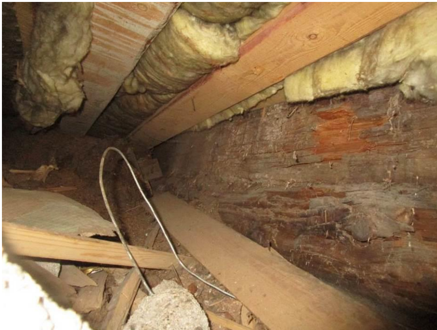
Kuva 12. Hirren pinta lahovaurioitunut.
