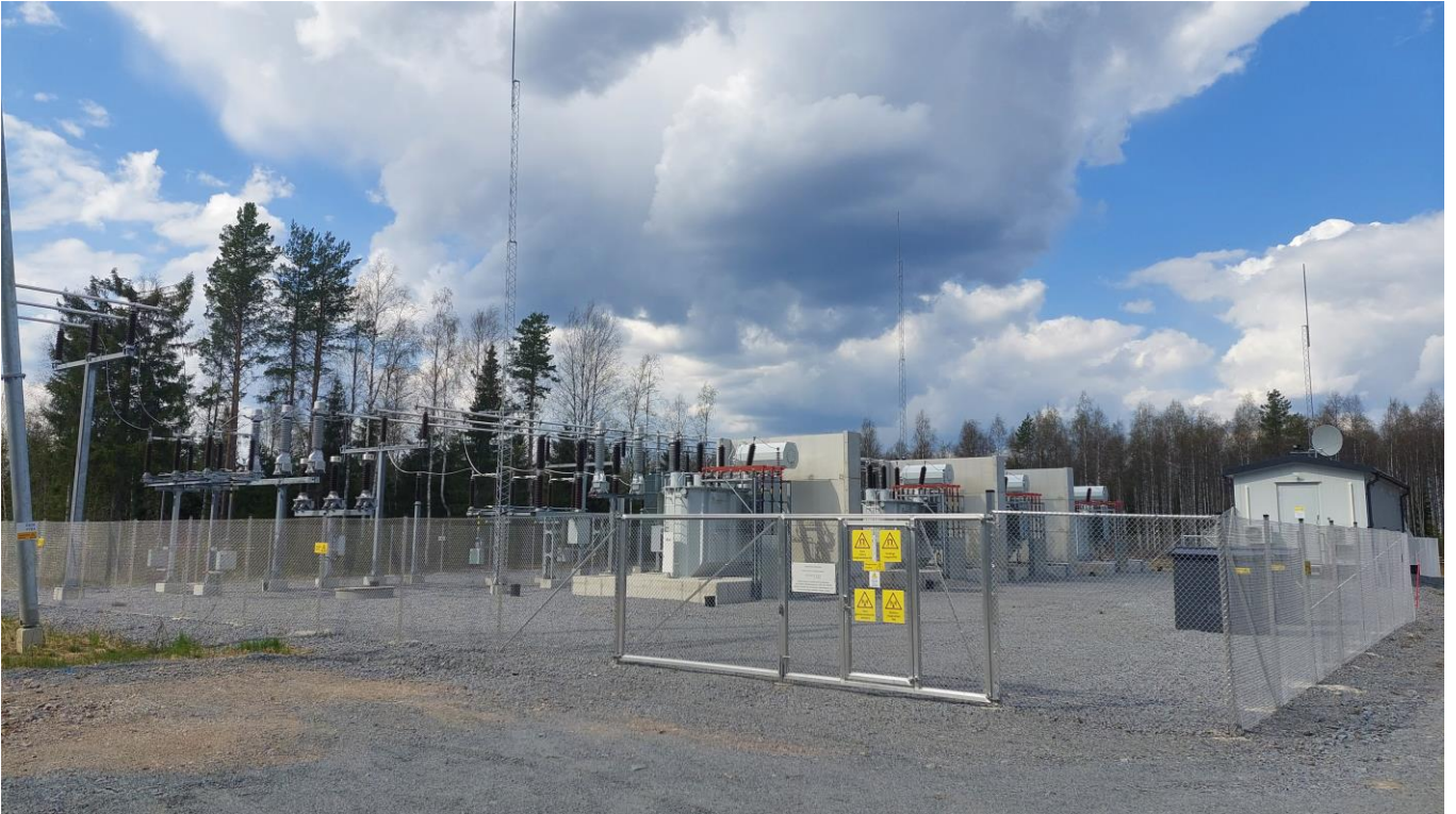
Kuva 23. Esimerkki tuulivoimapuiston sähköasemasta (Välikankaan tuulipuisto, Haapajärvi).
