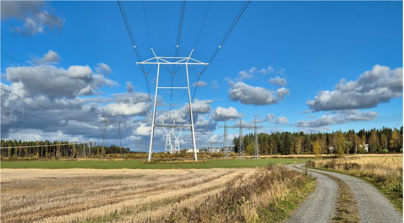
Kuva 3. Suunnittelualueen voimajohtoverkoston. Taustalla Pysäysperän sähköasema.
